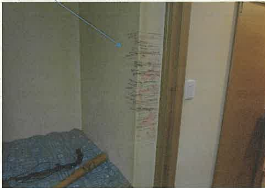
写真⑤ 内壁の汚れ
