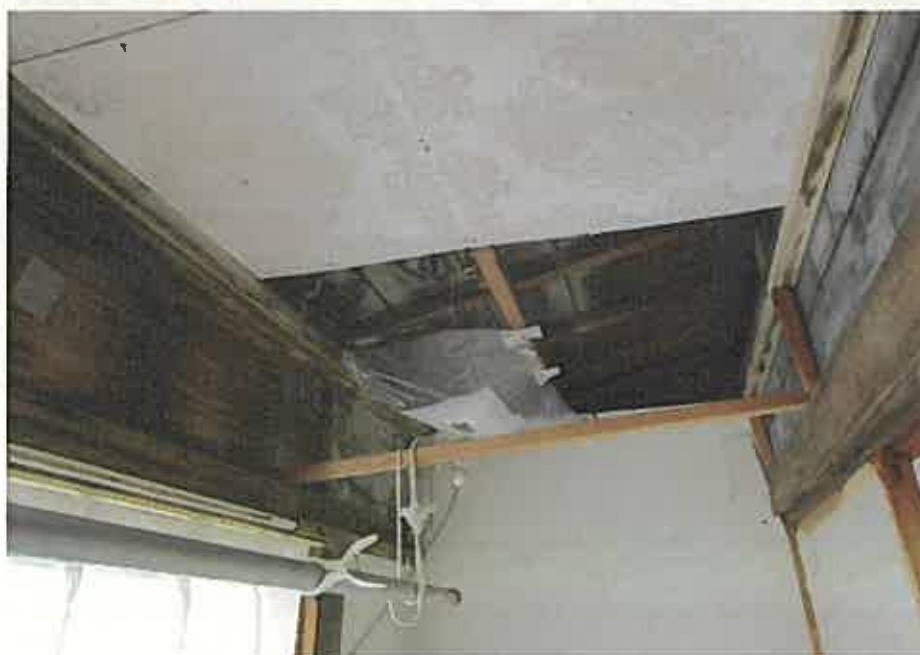
写真⑥ 天井の破損
