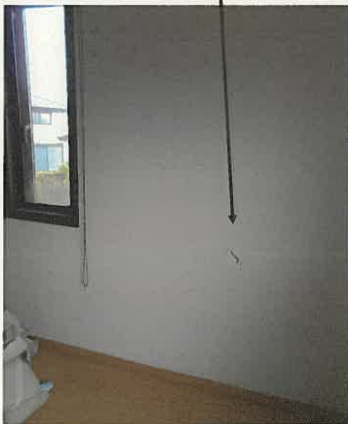
クロス壁の損傷箇所
