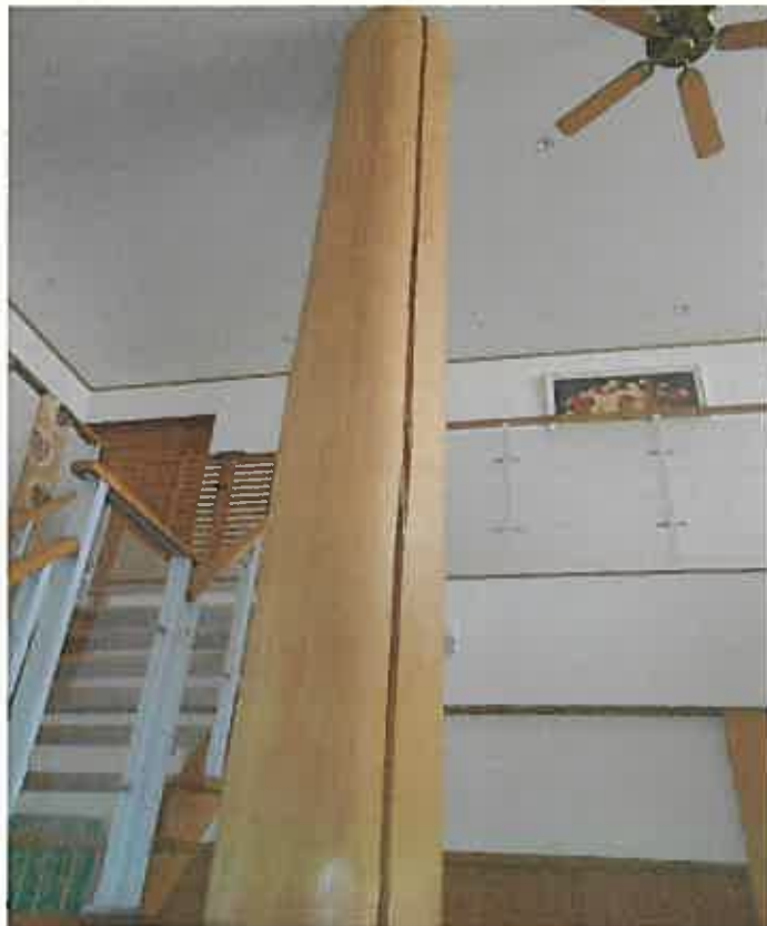
大黒柱の亀裂
