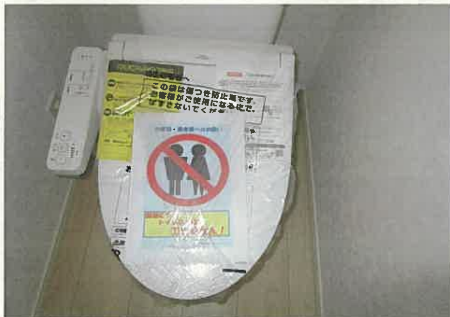
写真⑤ 未使用の便器
