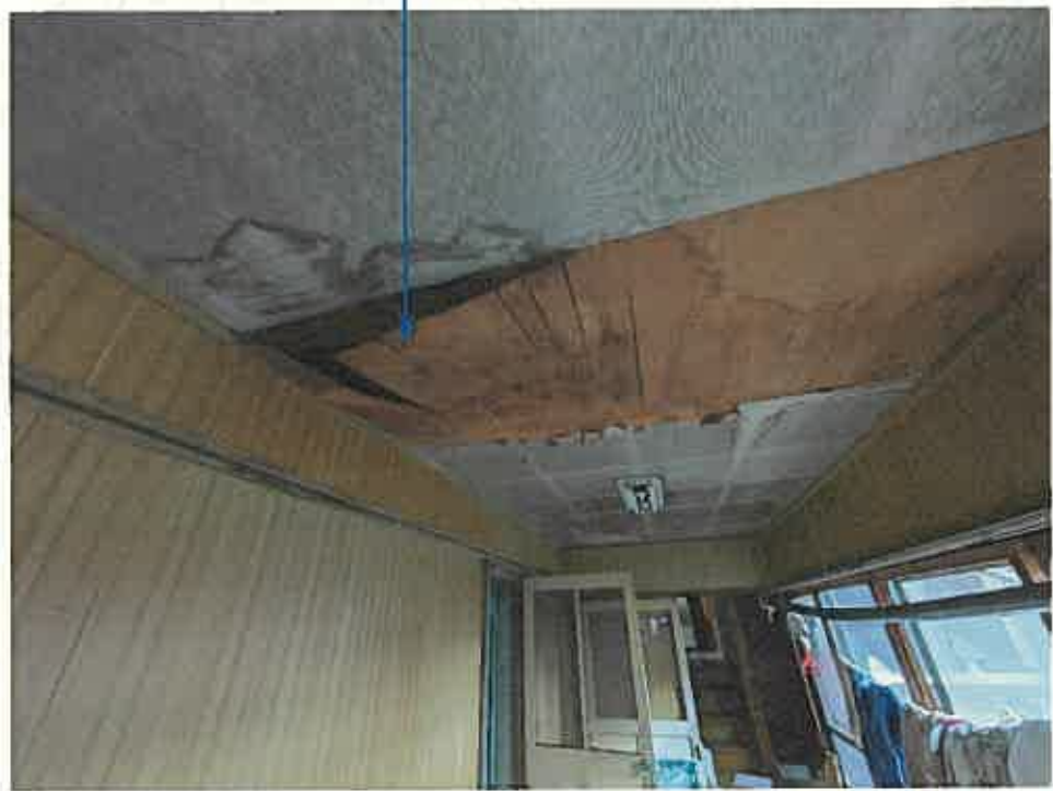
写 真 7 天井の破損部分
