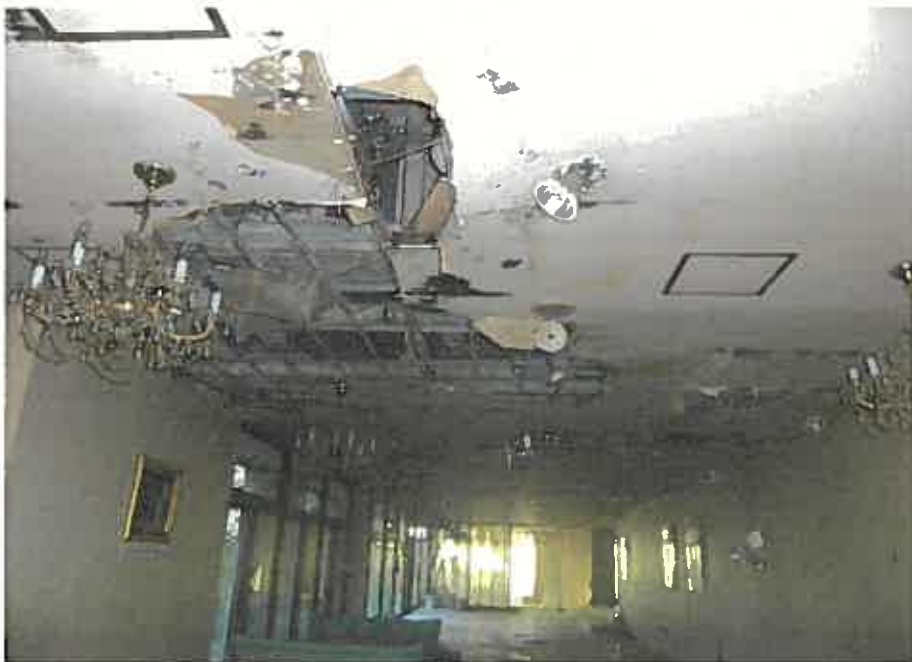
写真 18 天井の損傷状況
