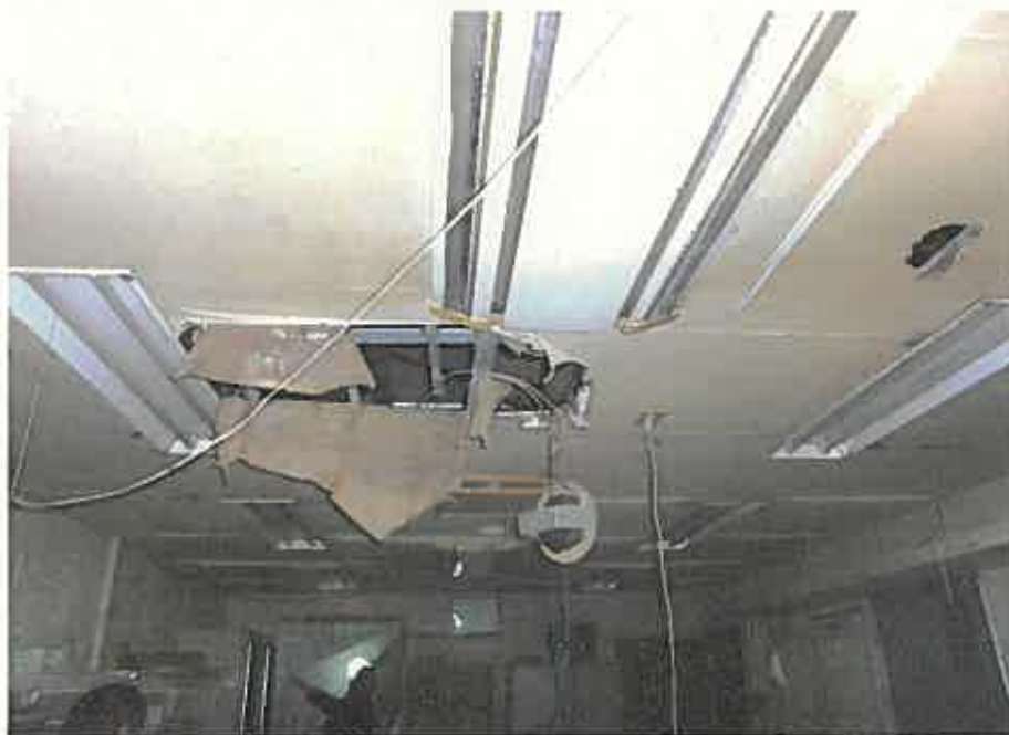
写真 2 2 天井の損傷状況
