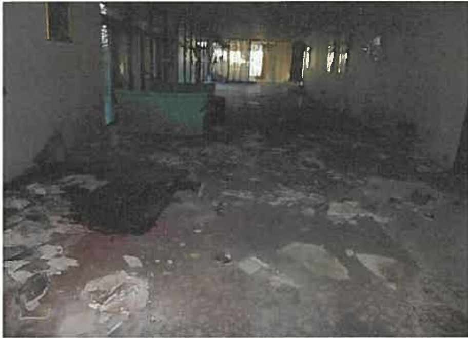
写真 17 天井板等が床に散乱している状況
