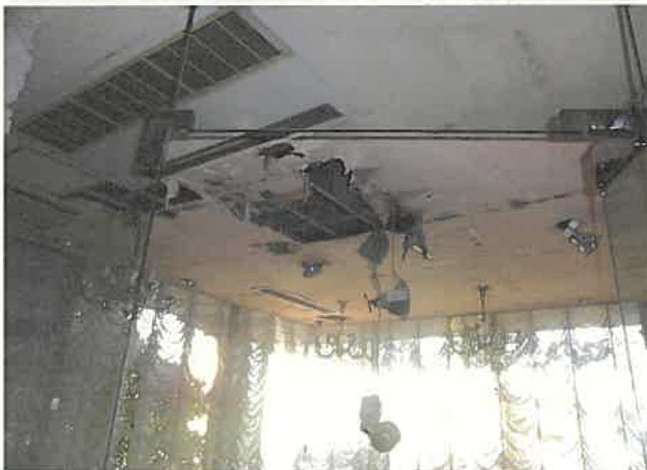
写真 16 雨漏り跡及び天井の損傷状況
