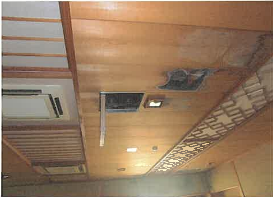
写真 4 雨漏り跡及び天井の損傷状況
