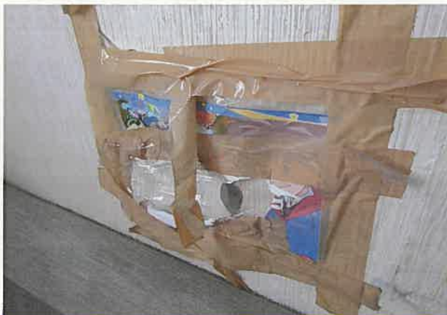
写真⑤ 内壁の損傷
