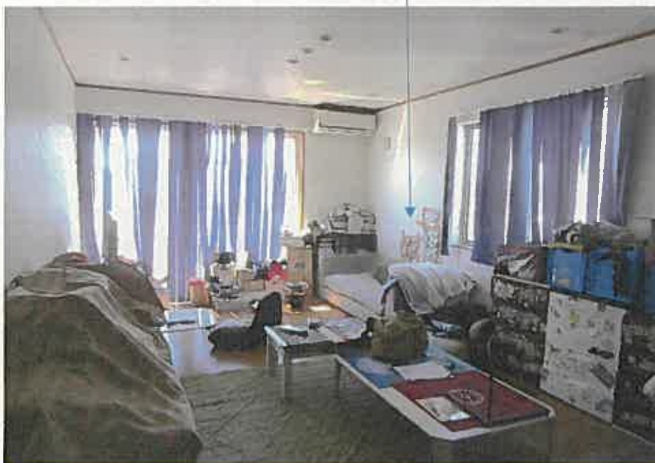
写真③ 以下、物件1の内部の状況 内壁の損傷
