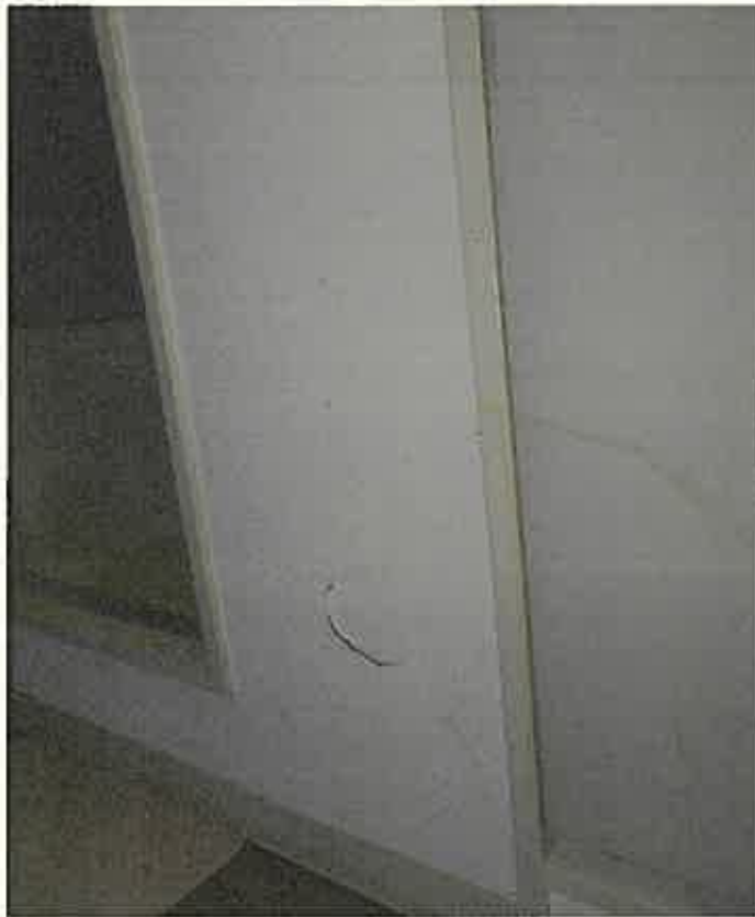
クロス壁に生じた窪み
