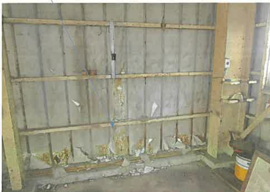
写真⑧ 壁の損傷
