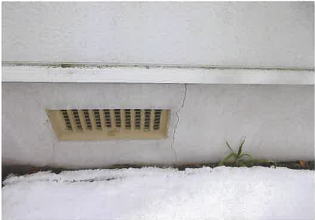
物件4:土台のひびの状況
