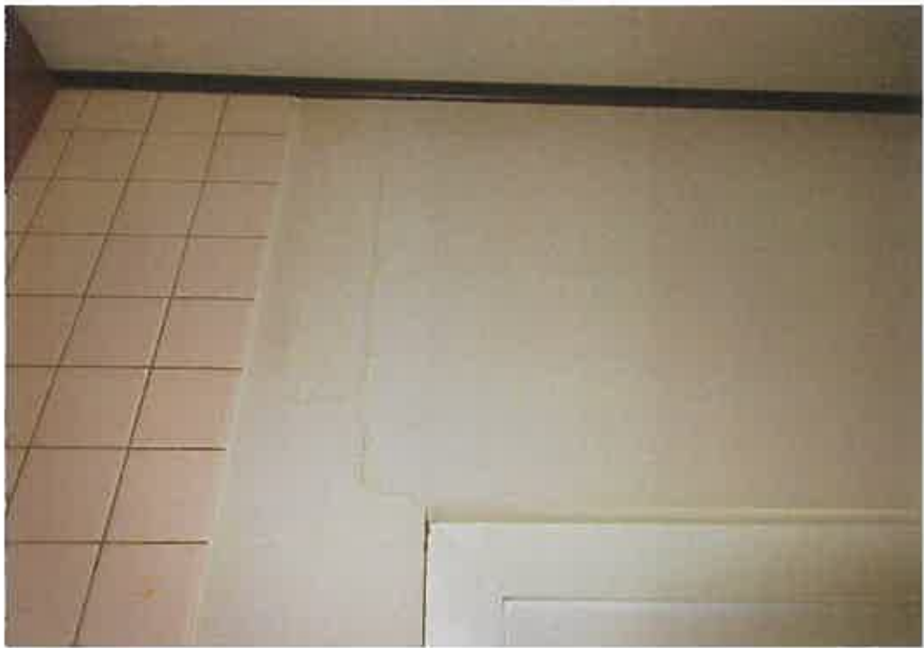
物件4:1階台所の内壁クロスのひび等の状況
