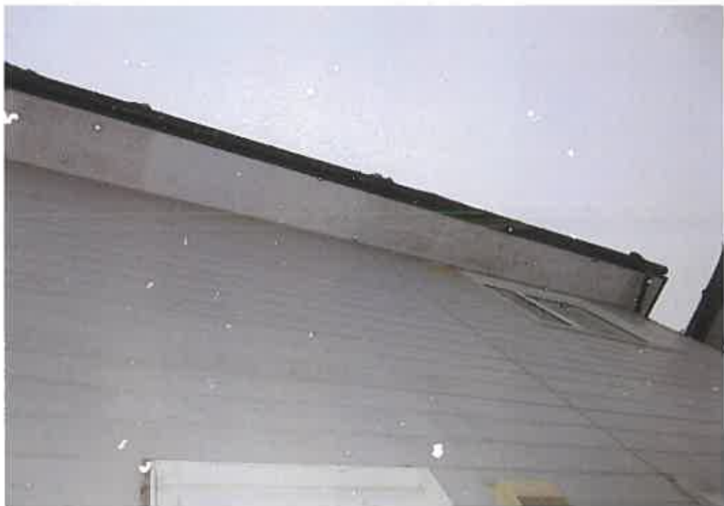
物件4:軒天の汚損の状況
