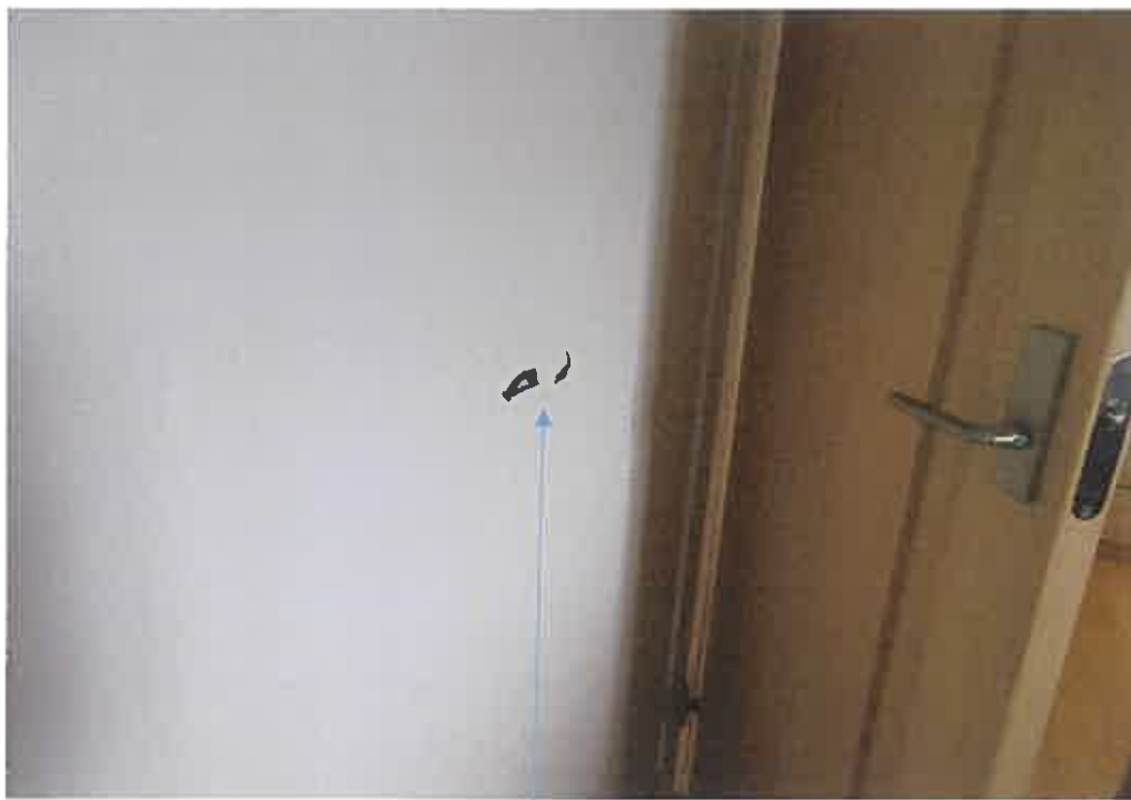
物件2:2階西側洋室の内壁の穴
