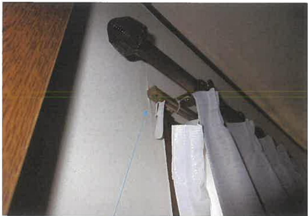
物件2:2階西側洋間の内壁クロスのひび
