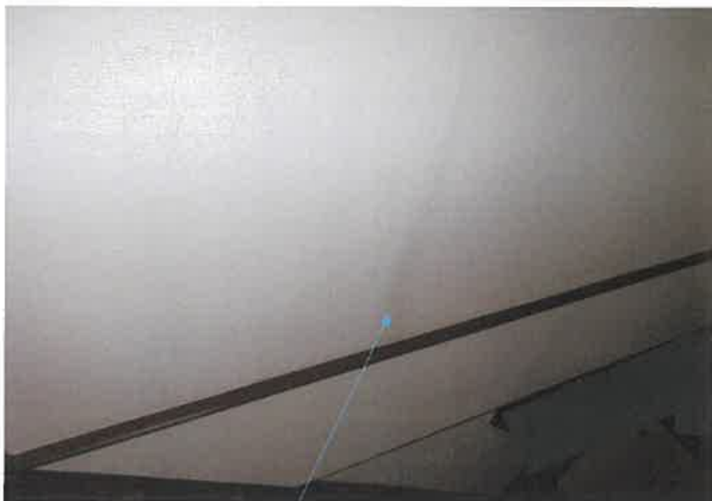
物件2:階段脇の修繕がなされた内壁クロス ひびの状況
