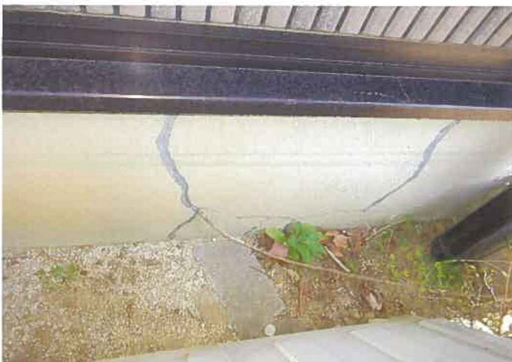
物件2:修繕がなされた土台のひびの状況
