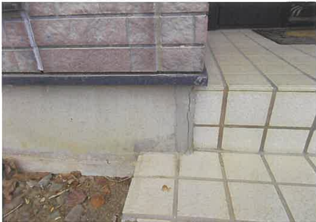
物件3:土台のひび等の状況
