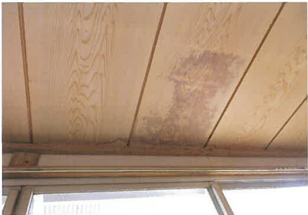
物件7:2階西側和室の天井のしみの状況
