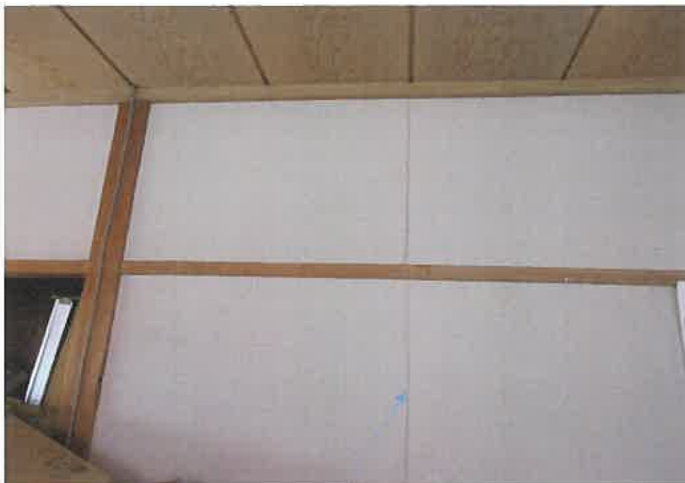
物件7:1階西側和室の内壁のひび
