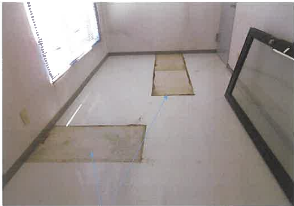
物件2主である建物:2階工場部分の床の汚損等
