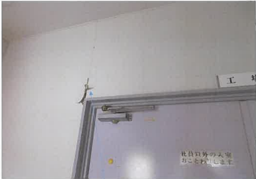
物件2主である建物:1階ホールの内壁のひび
