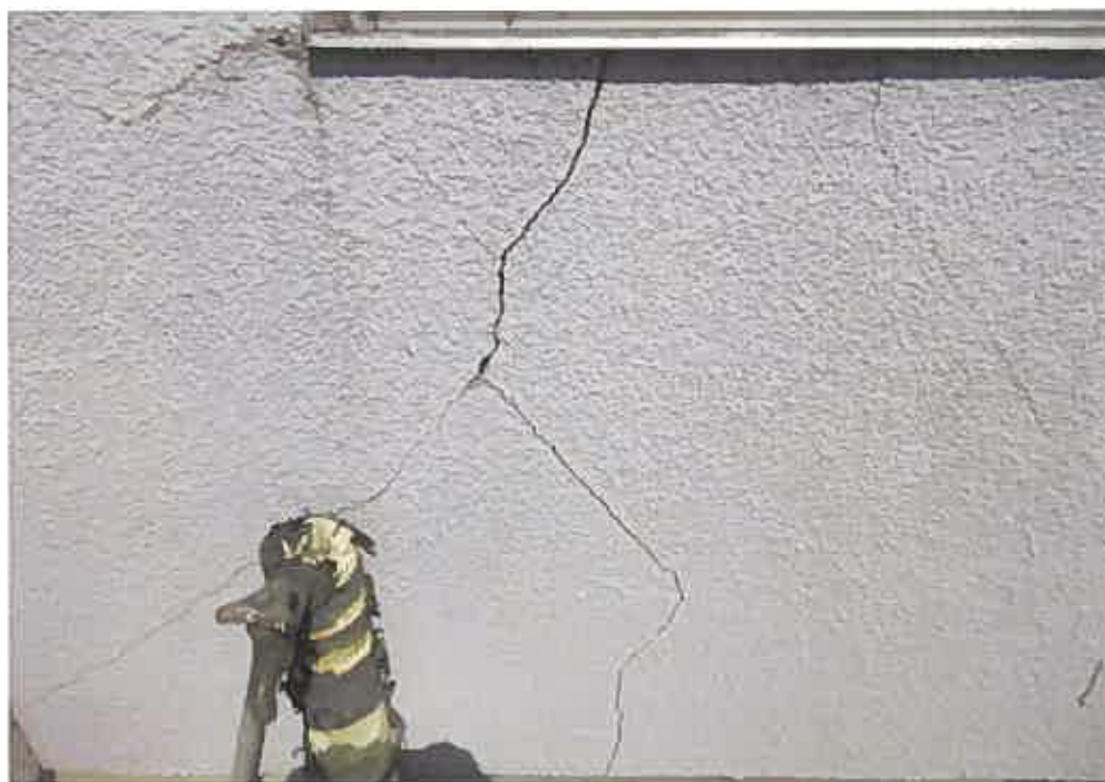
物件7:西側の外壁のひびの状況
