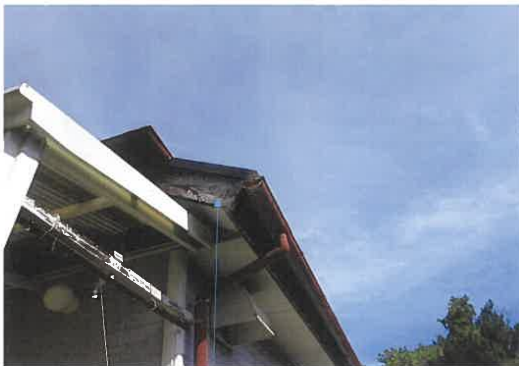
物件2:1階けば部分の塗装の剥がれ等
