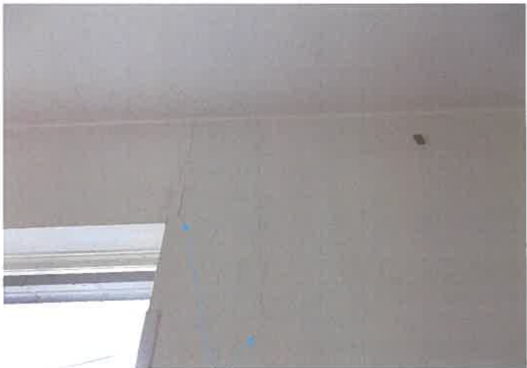
物件2:1階ホールの内壁クロスのひび
