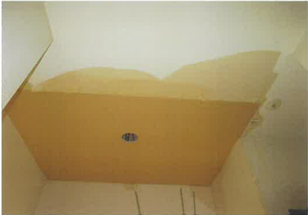
物件2:1階廊下の北側の天井の状況
