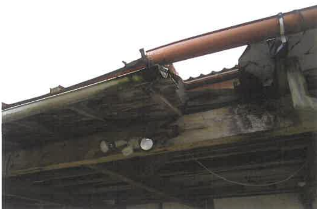
物件3:下屋部分の損傷等の状況
