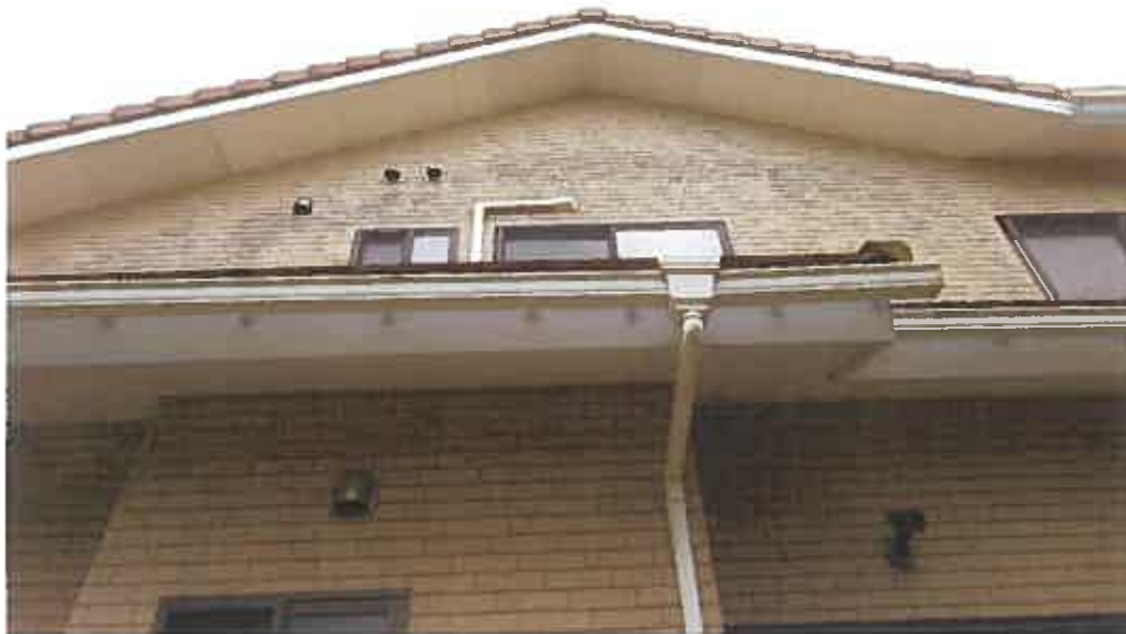
物件2:外壁の汚れ等の状況
