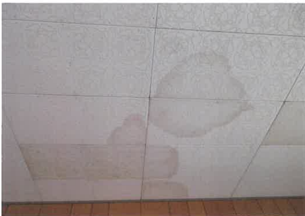
物件3:2階洋間の天井のシミの状況
