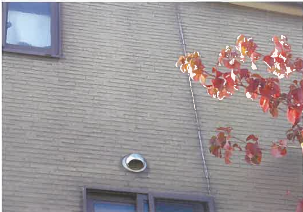
物件2:目地のひびの状況
