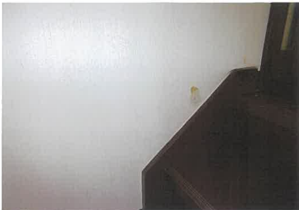
1階廊下の内壁クロスの損傷等の状況
