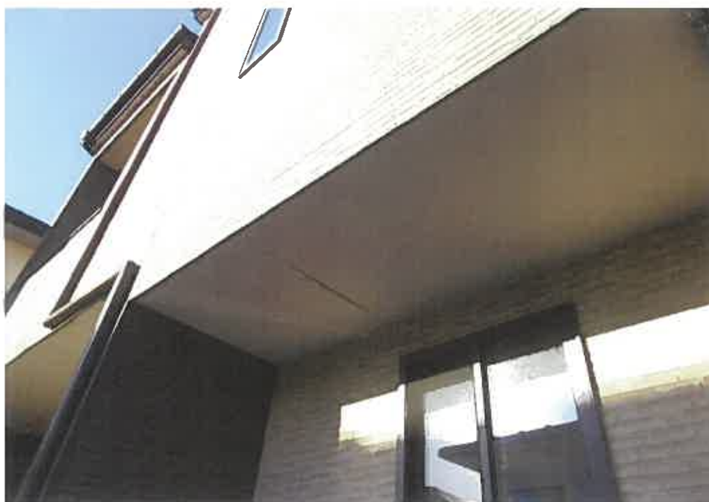
物件2: 軒天の剥がれの状況
