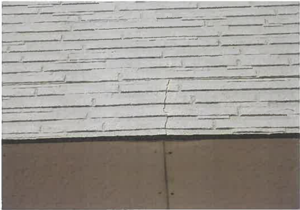
物件2:外壁のひびの状況
