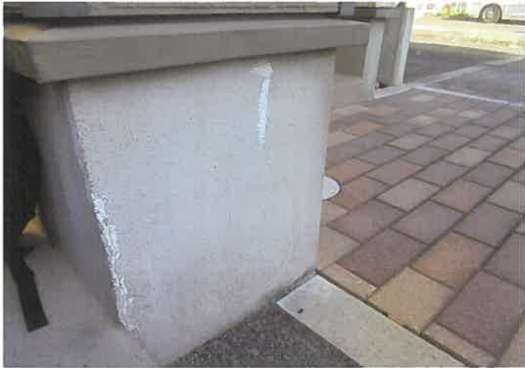
物件2:土台のひび等の状況
