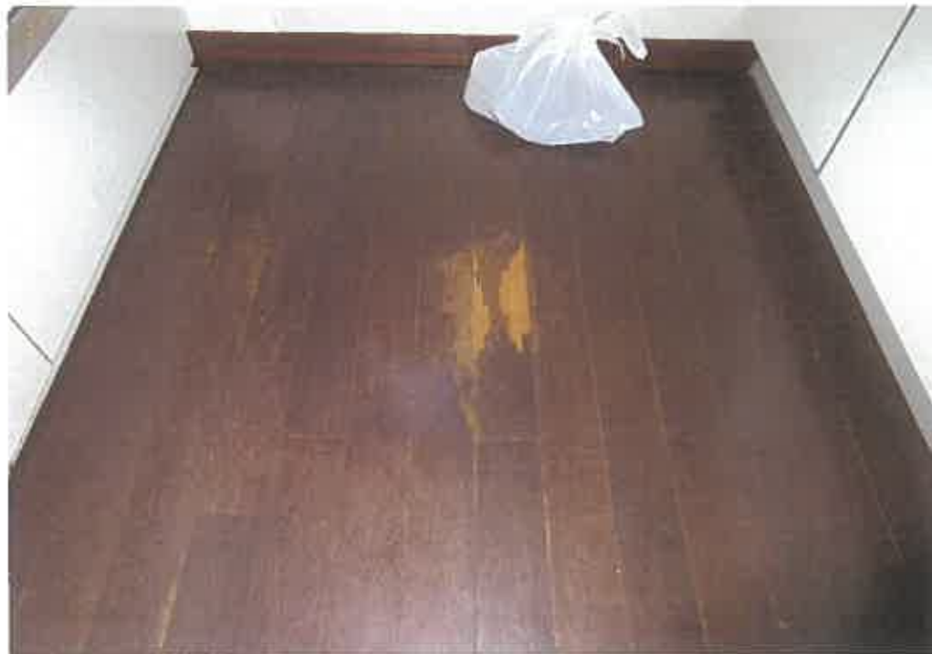
物件2:1階台所の床の損傷の状況
