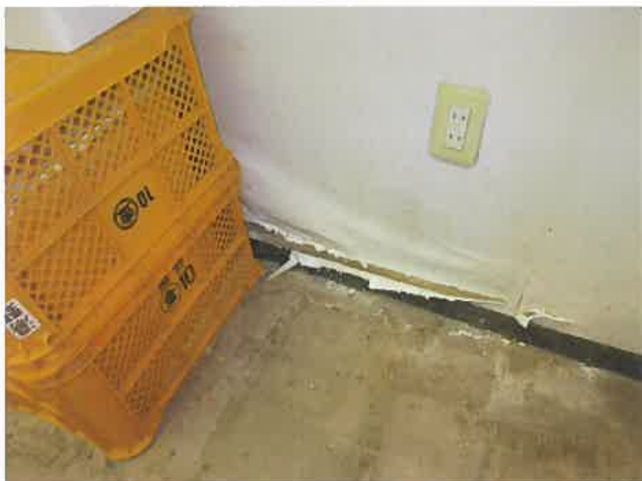
物件1:1階店舗内壁の剥離状況 No. 13
