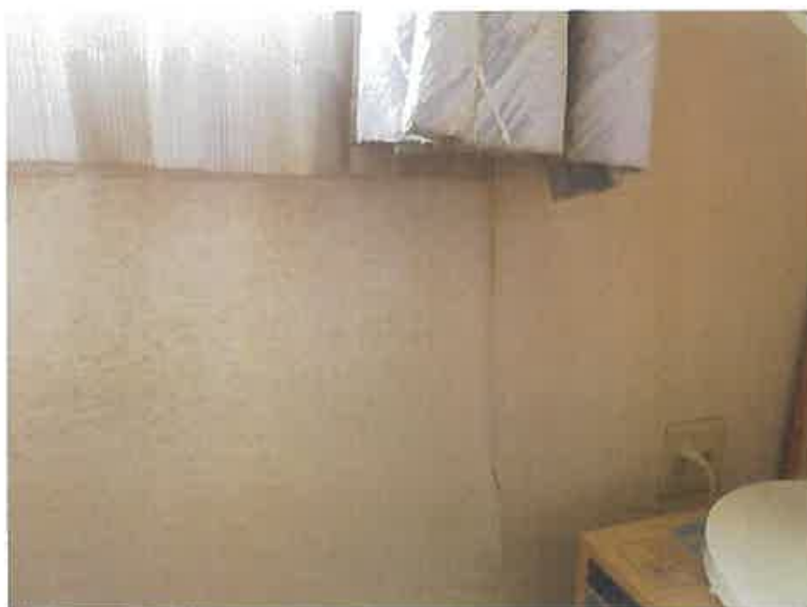
物件1:3階南西側洋室の壁クロスの亀裂 No. 14
