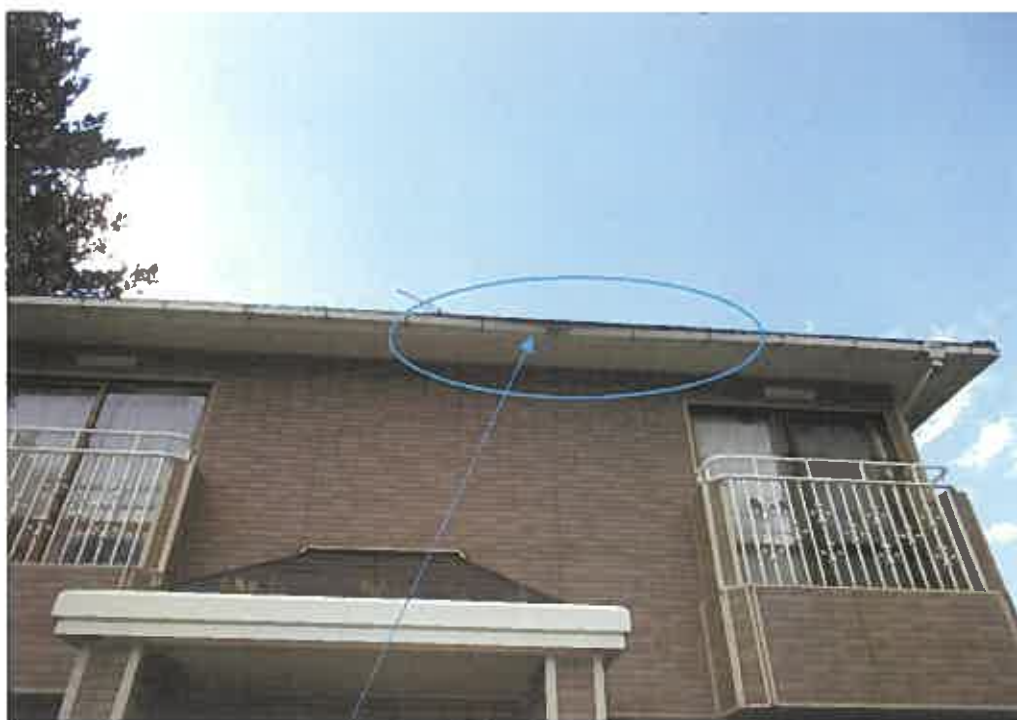
物件4: 雨樋のゆがみ等
