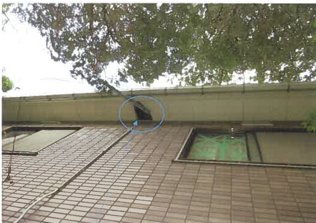
物件4: 西側軒天の損傷
