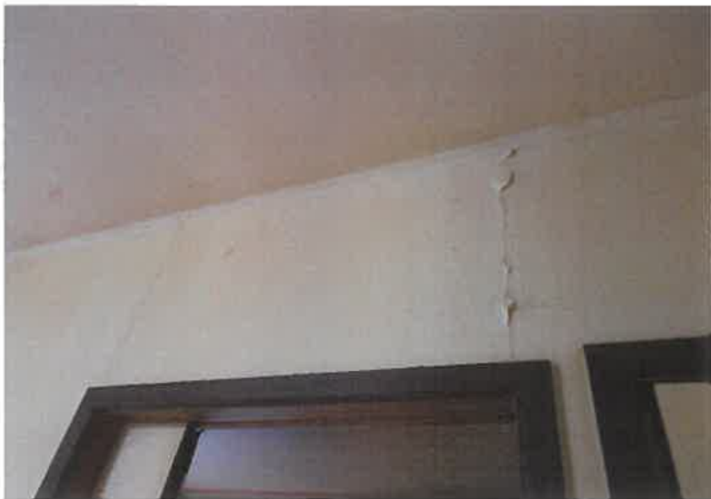
物件4:1階廊下の内壁のひび等の状況
