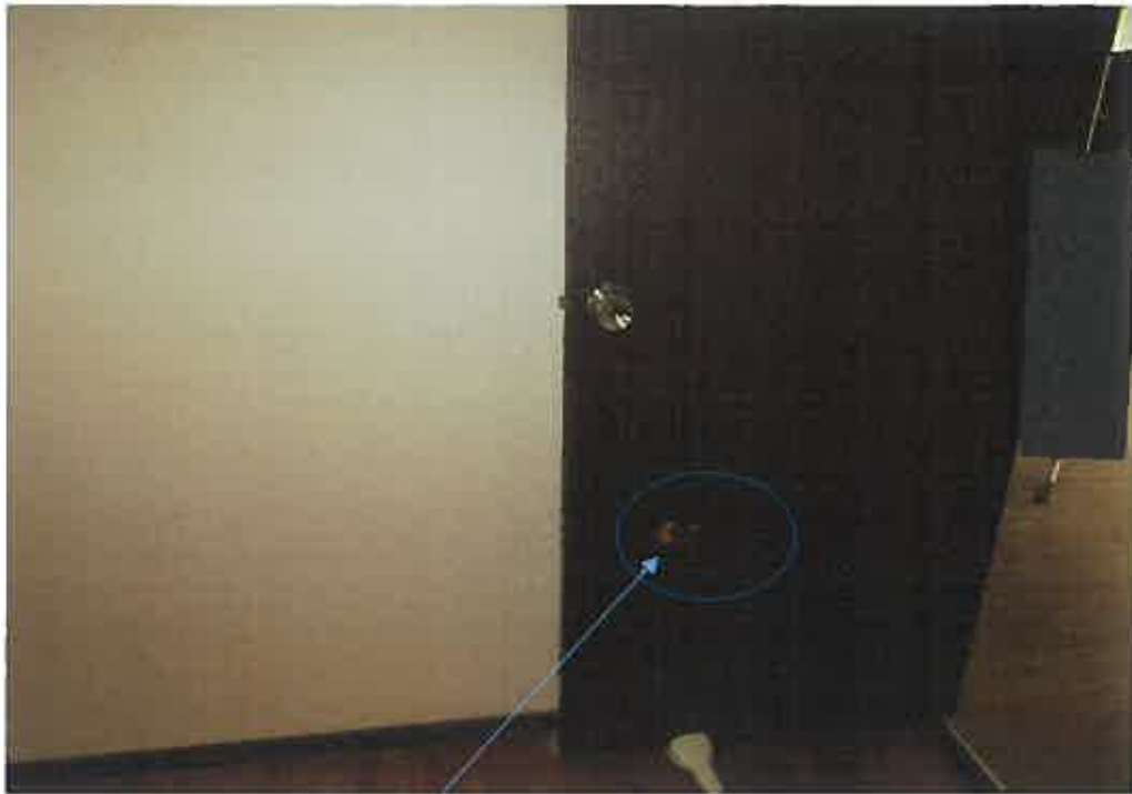
物件4:2階東側洋間のドアの損傷
