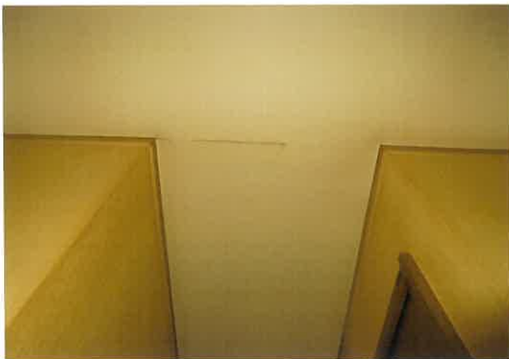
物件1:廊下の天井クロスのひびの状況
