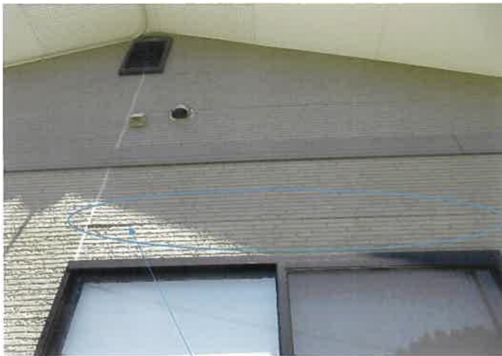
外壁の剥がれの状況
