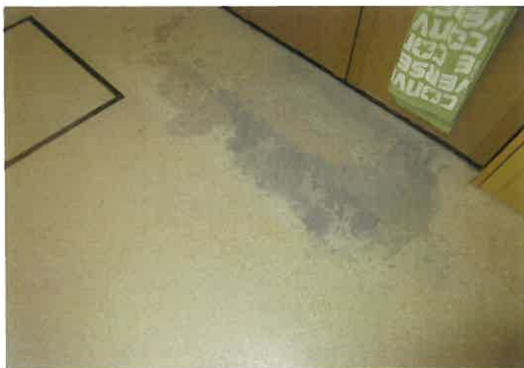
物件1:台所の流し台近くの床の腐食等の状況
