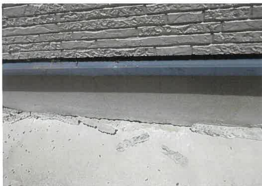
物件1:土台部分と犬走り部分との間の 隙間等の状況
