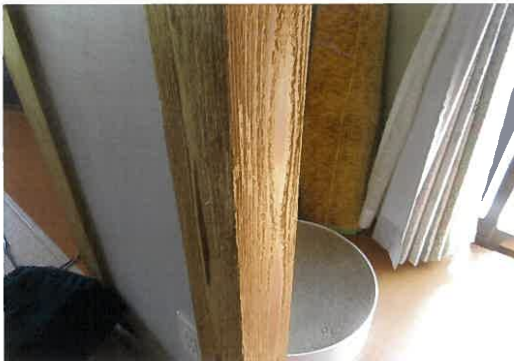
物件1:和室6帖1の柱の猫による引っ掻き傷の状況
