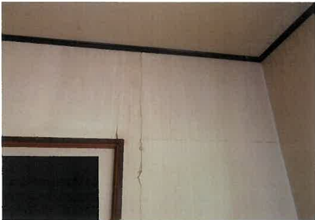
物件2主である建物:1階南西側和室の内壁 のひび等の状況
