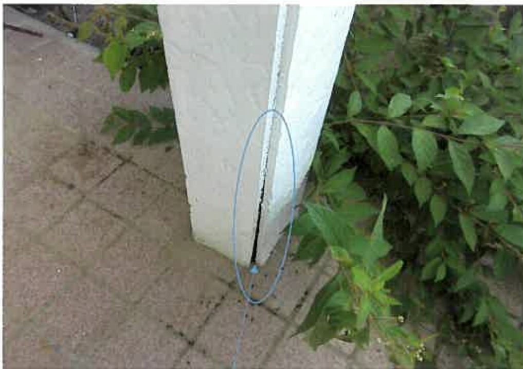
物件2主である建物: 玄関ポーチの柱の剥がれ
