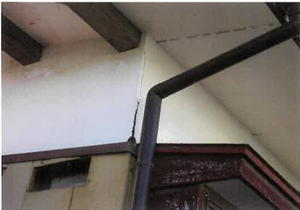
物件3:外壁のひびの状況
