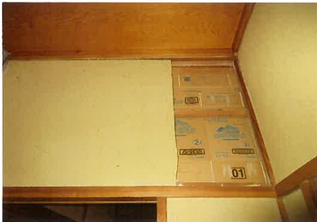
物件3:1階和室6帖の内壁の損傷等の状況
