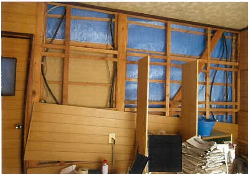
物件3:1階洋室の北側の内壁の崩落の状況
