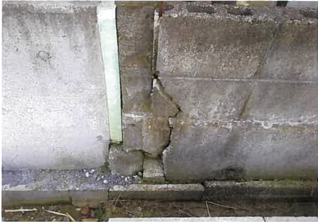
物件2:ブロック塀の損傷の状況
