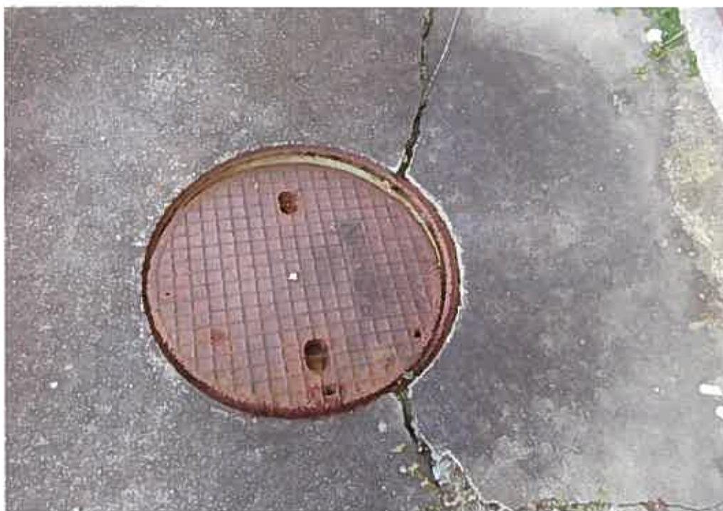
物件2:浄化槽設置部分のひびの状況
