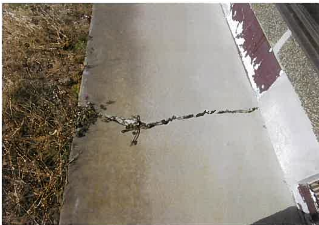
物件2:犬走り部分のひびの状況
