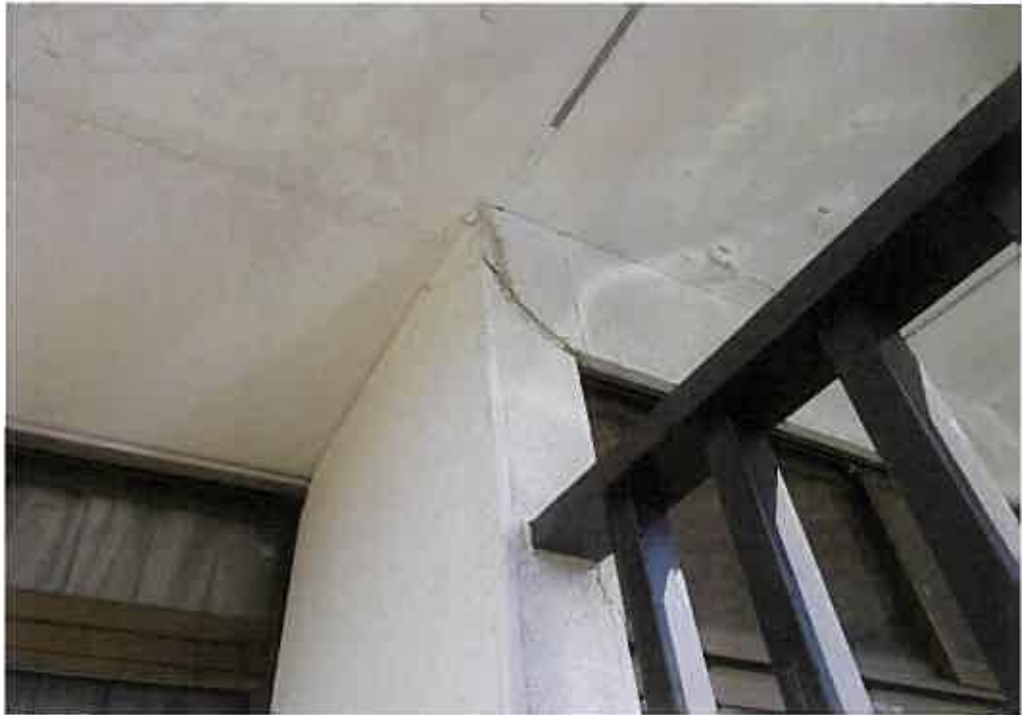
物件3:外壁のひびの状況
