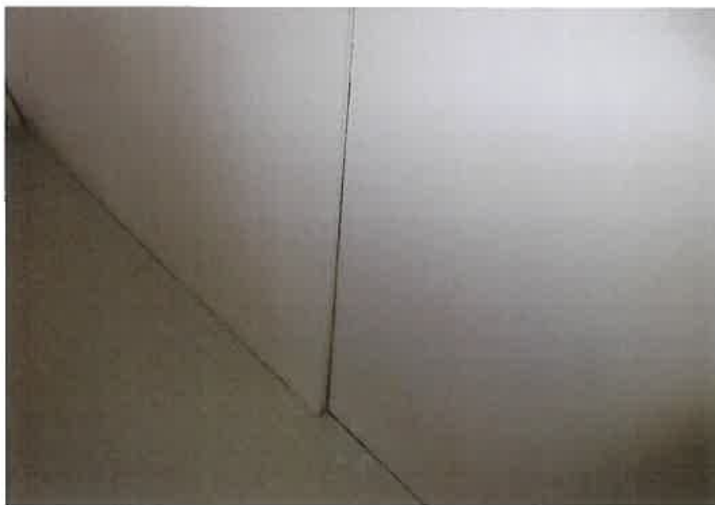
物件3:1階浴室のずれた壁の状況
