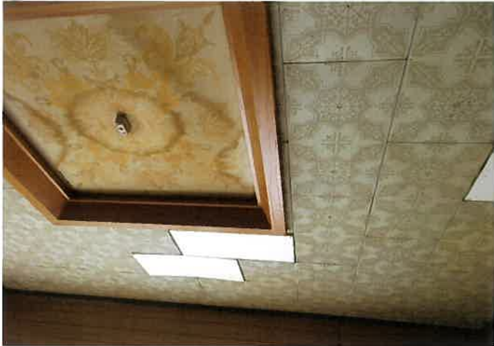
物件3:1階洋室の天井の損傷やしみの状況
