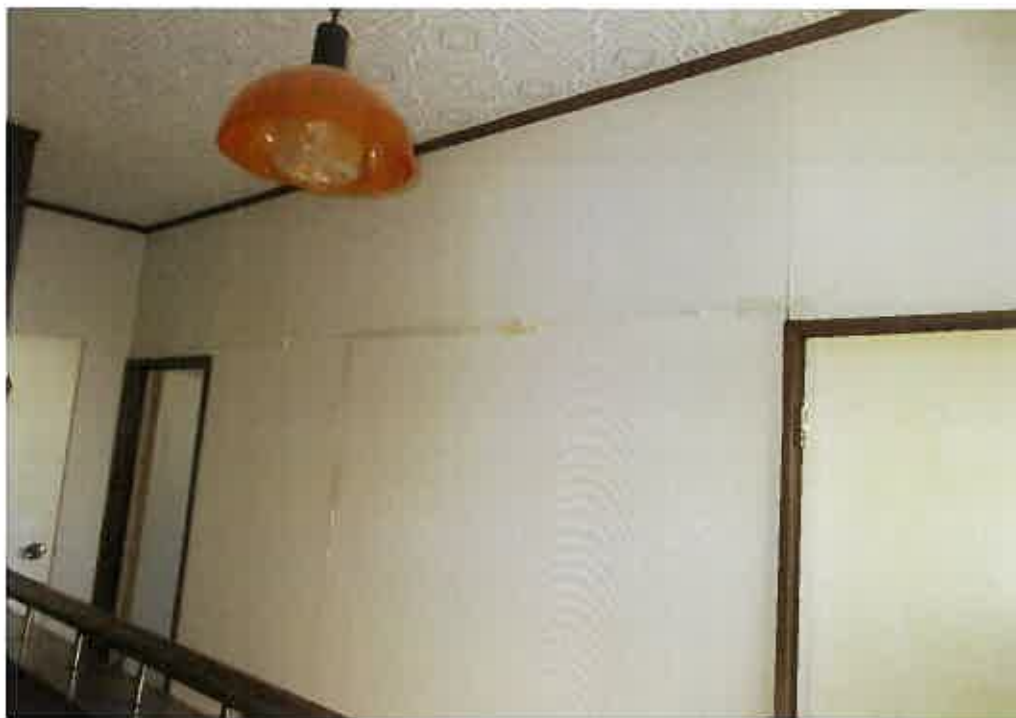
物件3:2階廊下の洋室側の内壁クロスのひびの状況
