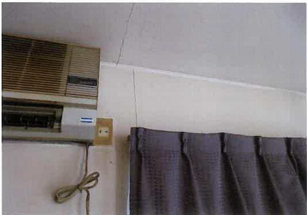
物件5:1階洋室(リビング・ダイニング)の内壁 クロスや天井のひび等の状況
