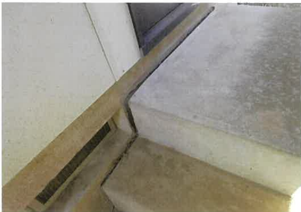
物件5:勝手口ステップ部分と建物本体との間の隙間の状況
