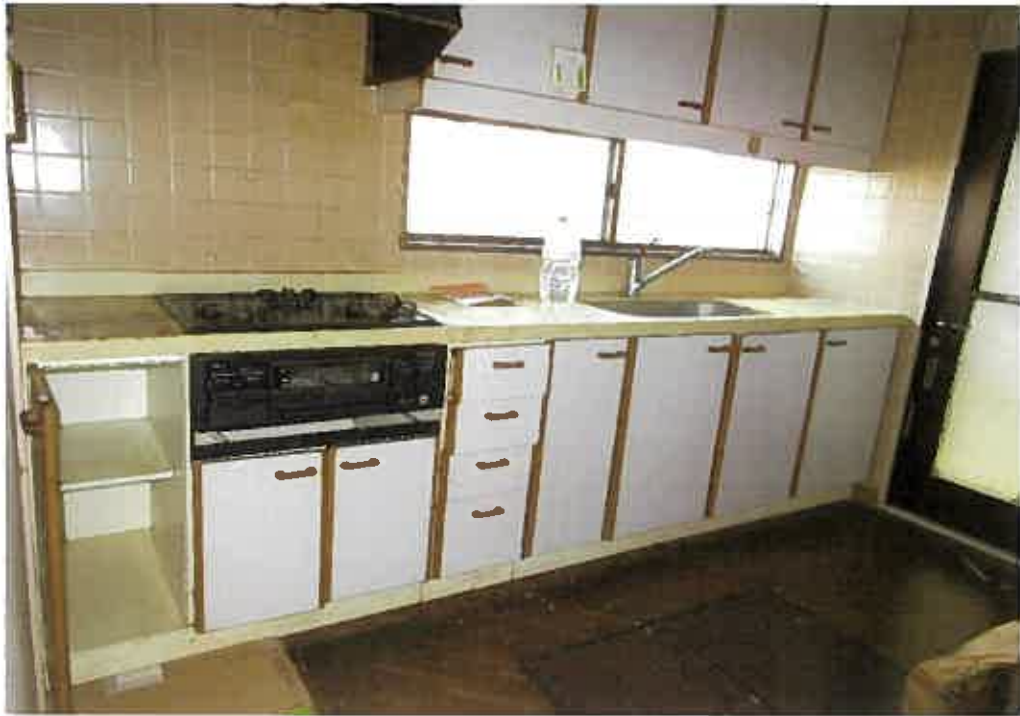
物件5:1階台所の状況
