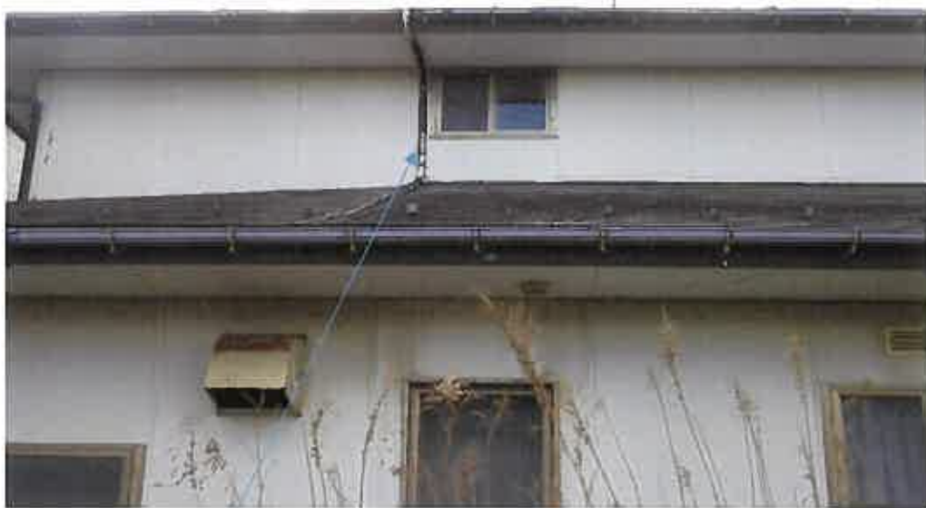
太陽熱温水器様のものの配管ホースが切断 されている状況
