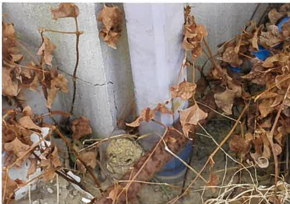
物件5:土台部分のひびの状況
