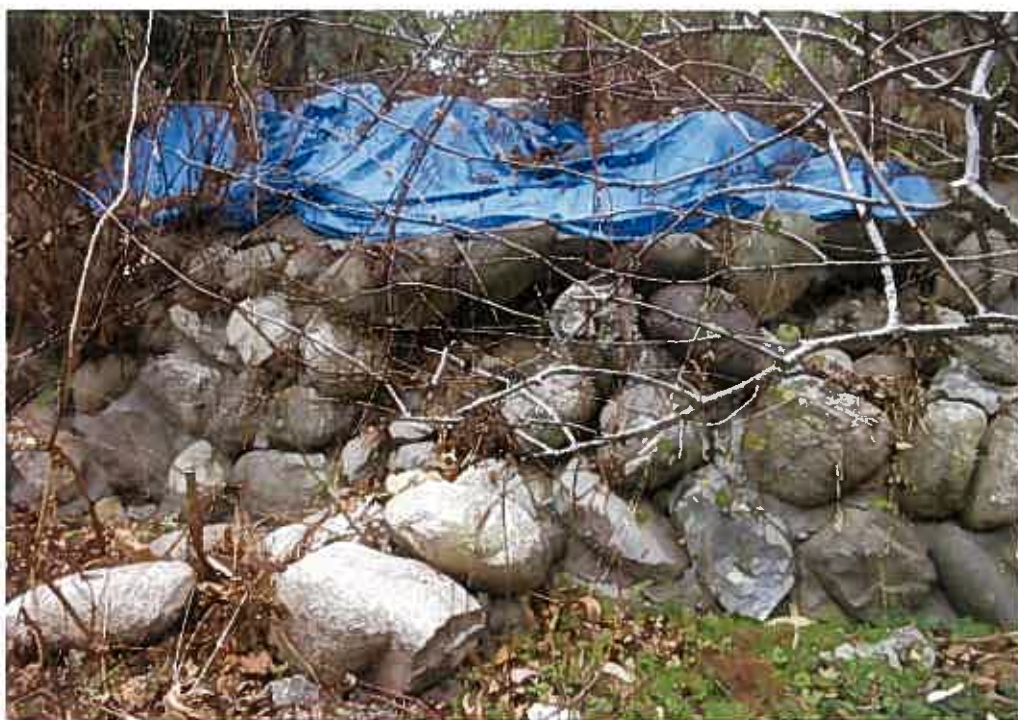
物件1：法面部分の石の崩落状況
