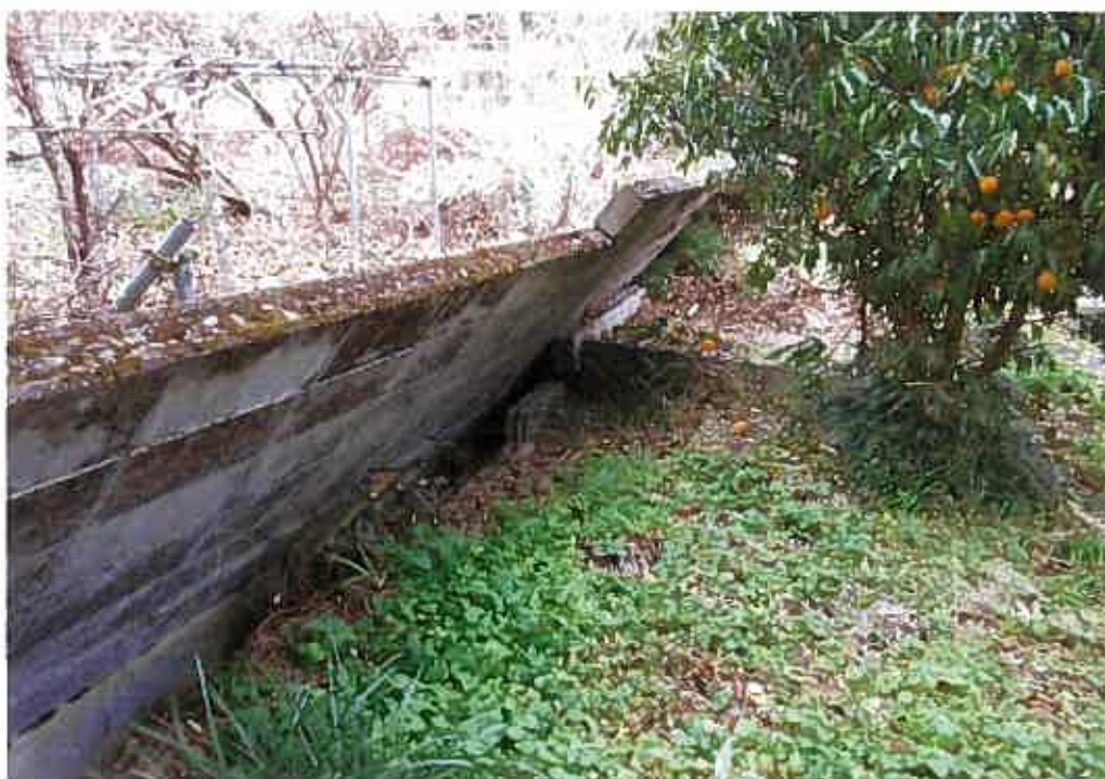
物件1：ブロック塀が傾いている状況
