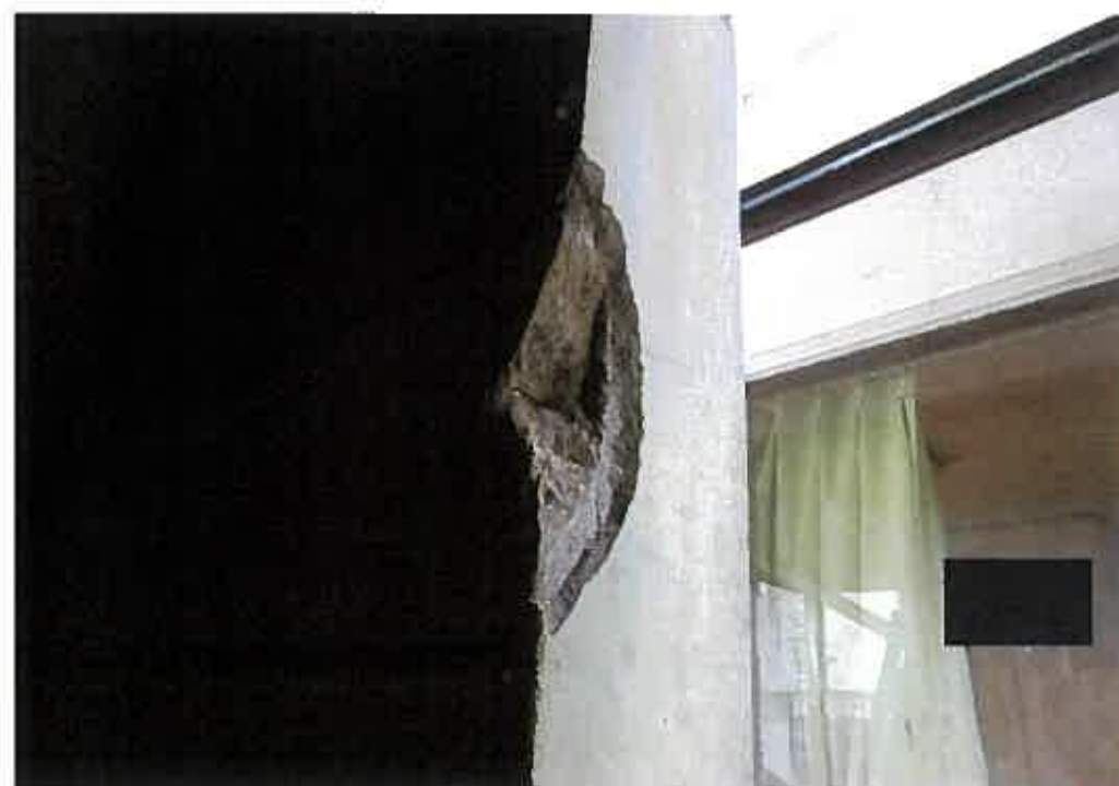
物件3附属建物:壁の損傷の状況
