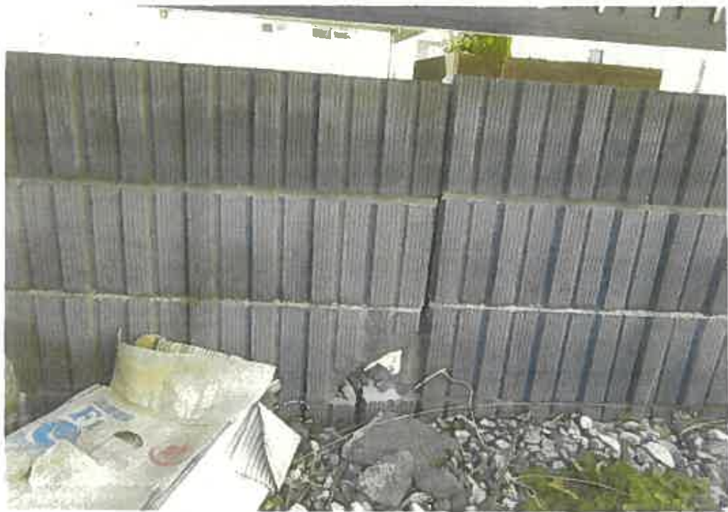
物件1土地上のブロック塀の損傷等の状況
