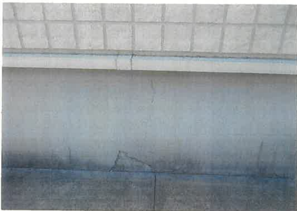
物件3:土台のひび等の状況
