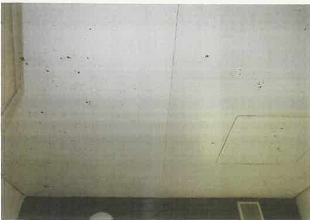
物件2:1階風呂の天井の汚損の状況
