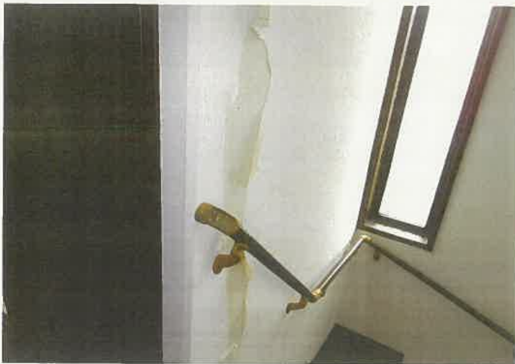
物件2:階段部分の内壁クロスの剥がれの状況
