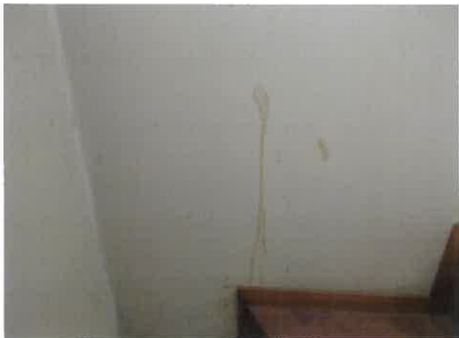
物件10:階段部分壁面の汚損状況
