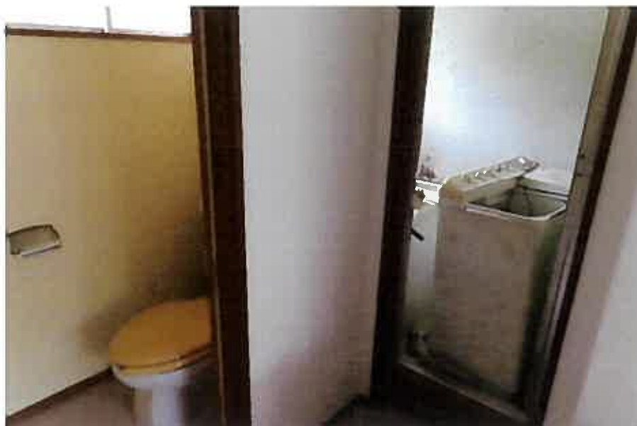
物件9主である建物: 2階203号室の浴室及び便所の状況
