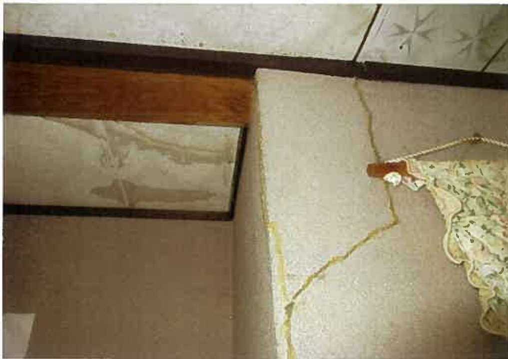
物件3主である建物1階:台所の内壁のひびや天井 のしみの状況
