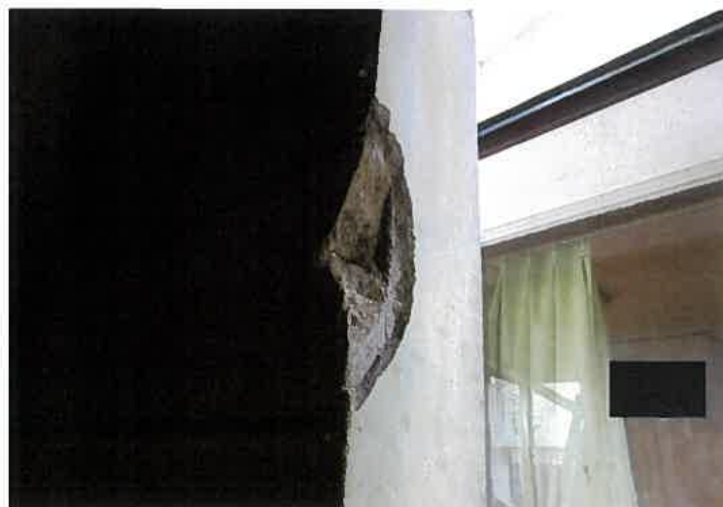
物件3附属建物:壁の損傷の状況
