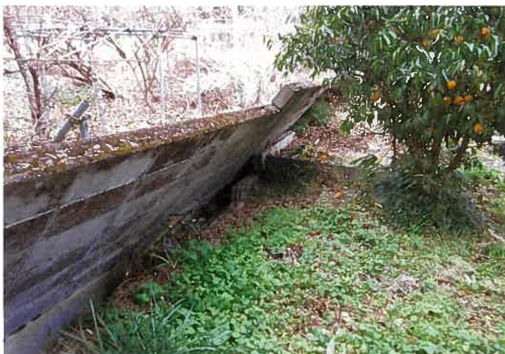
物件1:ブロック塀が傾いている状況
