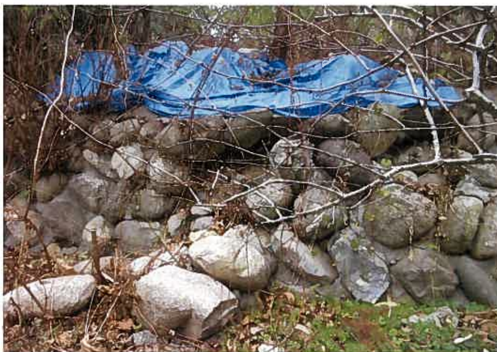
物件1:法面部分の石の崩落状況
