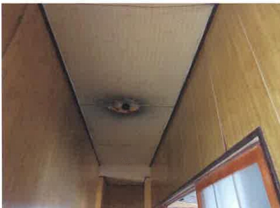
物件2:2階廊下の天井の損傷等の状況
