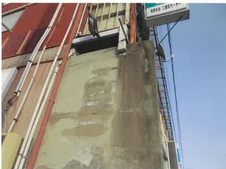
物件2:外壁のひび等の状況
