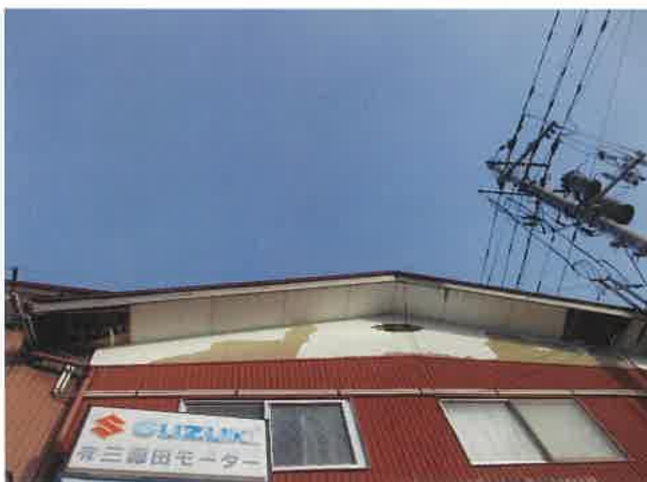
物件2:軒天や壁の損傷等の状況
