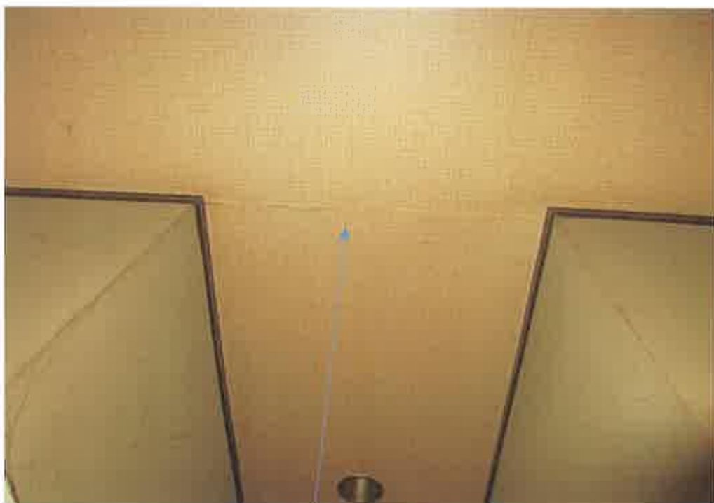
物件2主である建物の天井のひび等の状況
