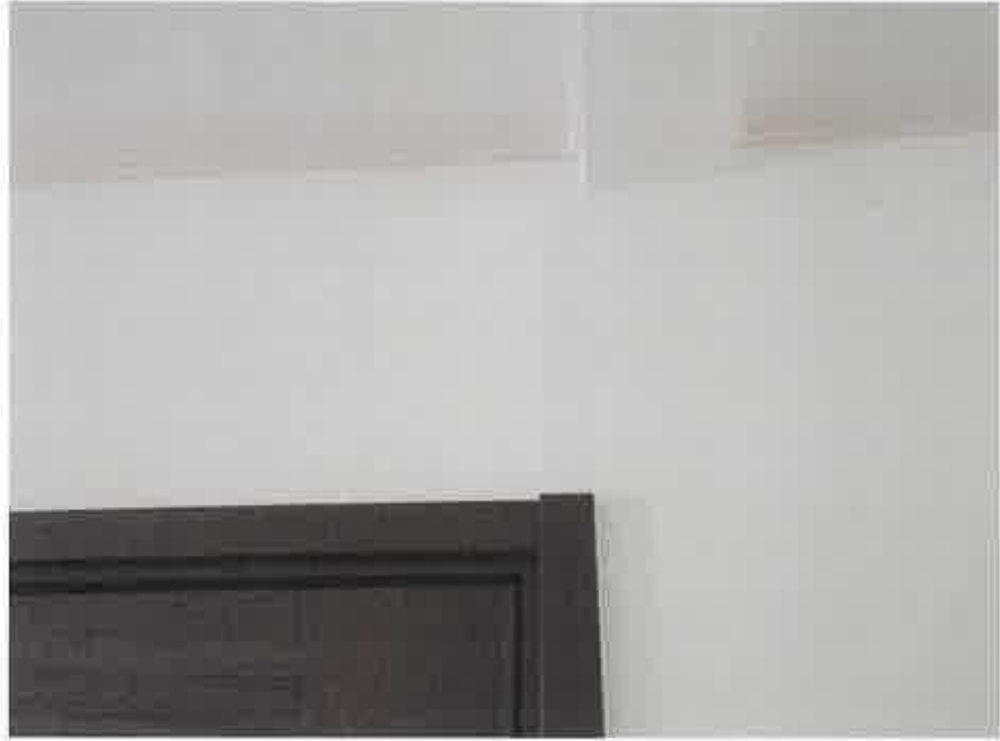
物件3:2階廊下壁クロスの亀裂
