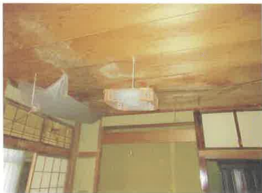
物件3主である建物1階浴室向かいの和室の天井の腐食状況
