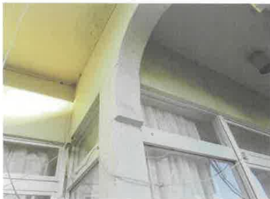
物件3主である建物の外壁のひび等の状況
