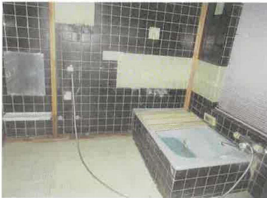
物件3主である建物:1階浴室の状況 No. 17
