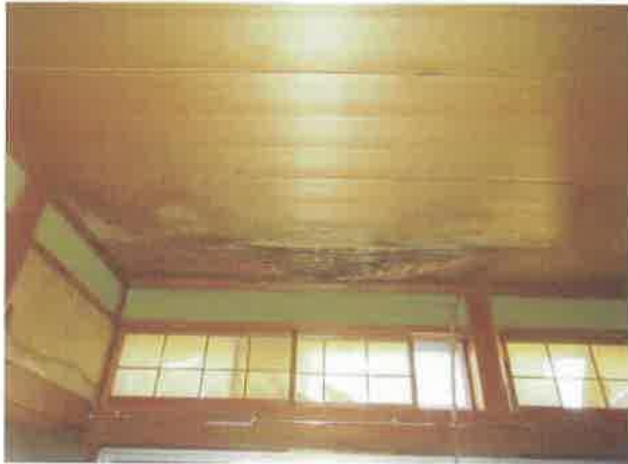
主である建物(別棟)2階の南側和室の 天井等の腐食状況
