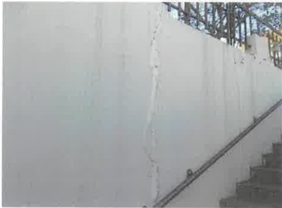
南東側階段のひびの状況
