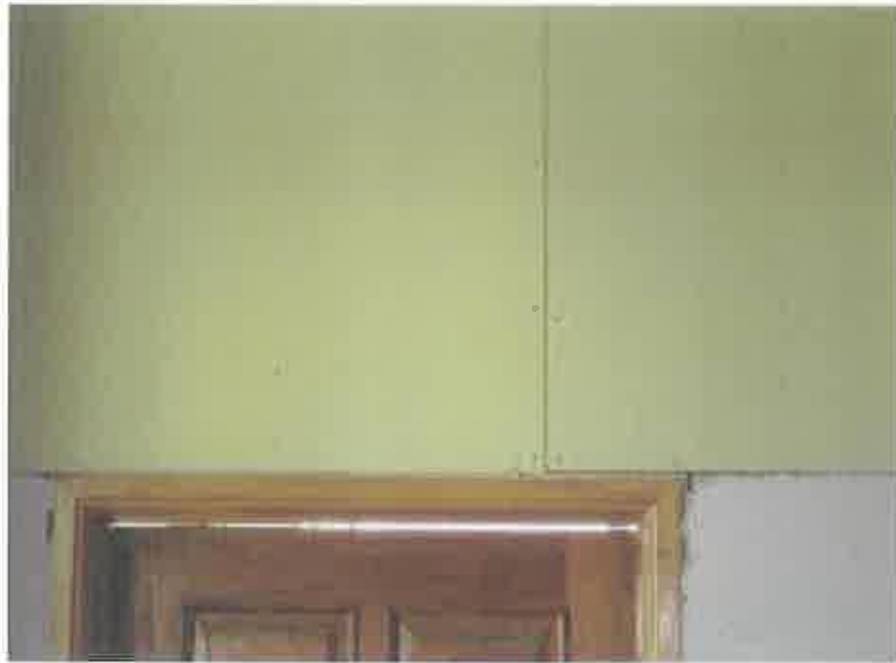
物件3主である建物1階玄関内側の損傷状況
