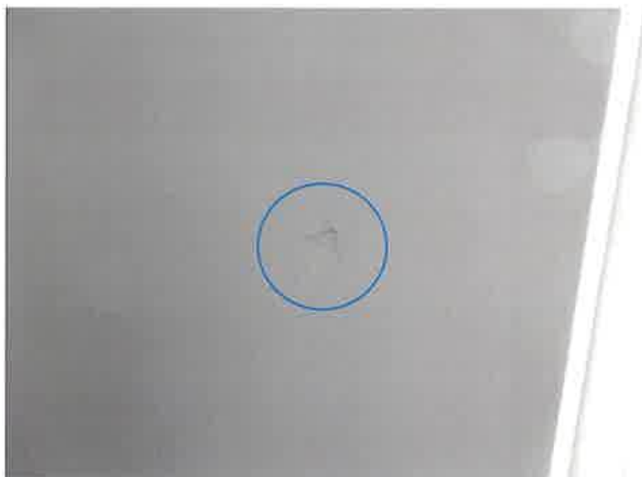
物件2:2階西側洋室内の壁の穴
