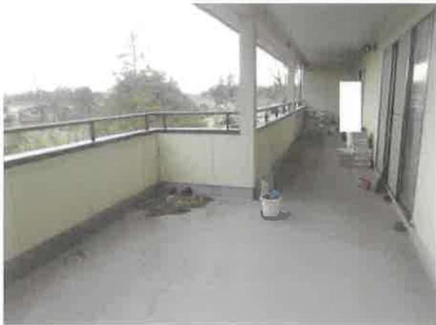
物件3:2階ベランダの状況
