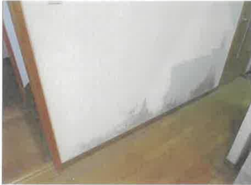
物件3:1階東側食堂の壁クロス
