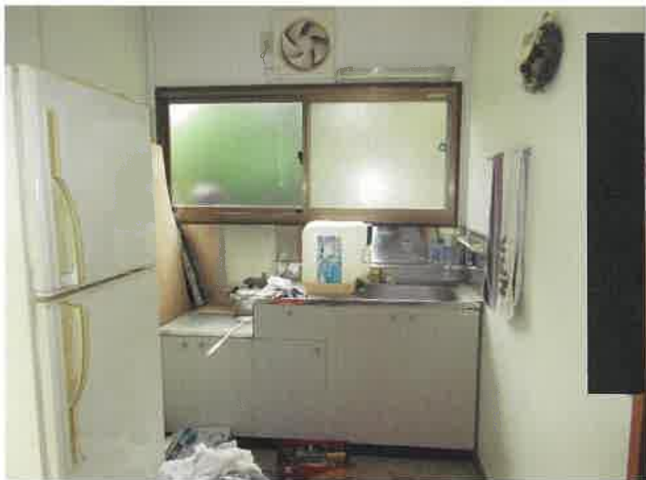
物件1:未登記附属建物の台所の状況
