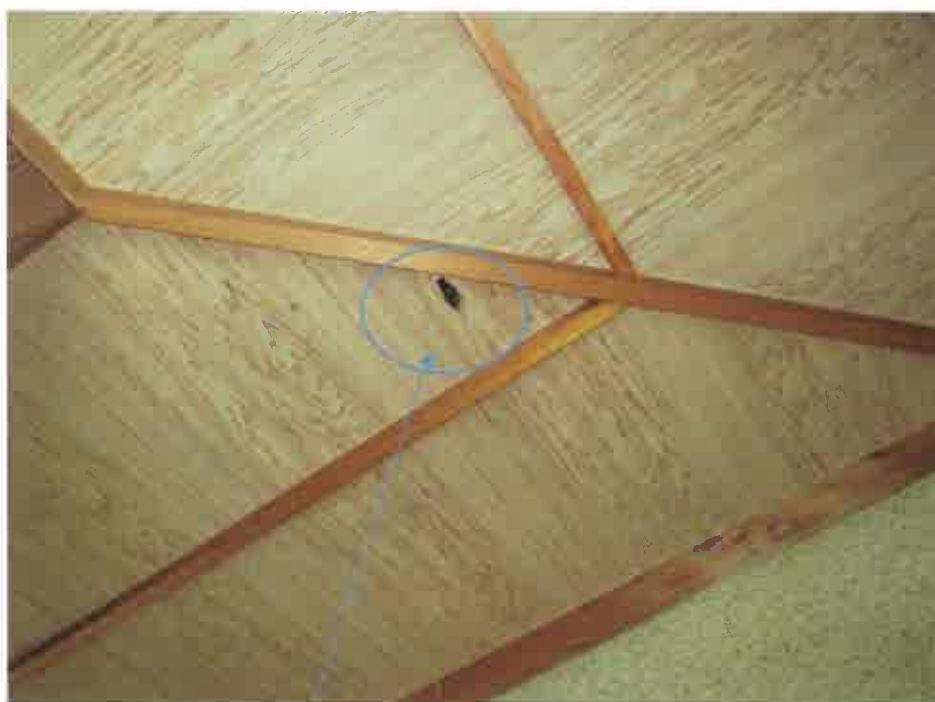
物件1:主である建物2階の廊下の天井の破損
