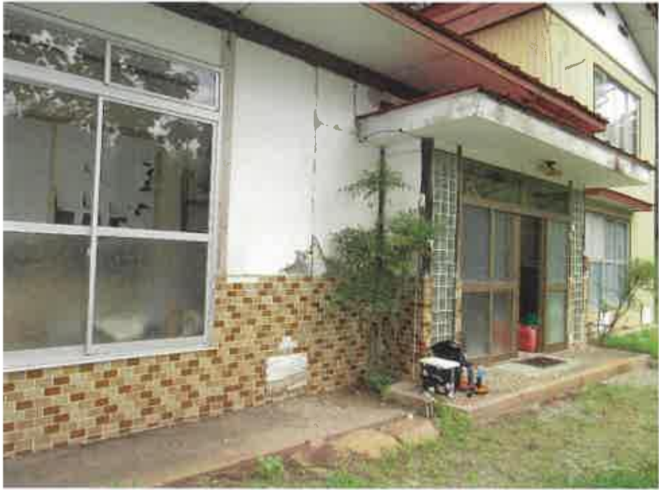
物件1主である建物の外壁のひび等の状況 No. 3
