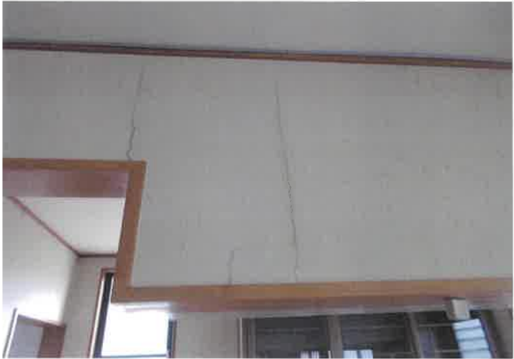
物件2:1階LDの内壁のひび等の状況
