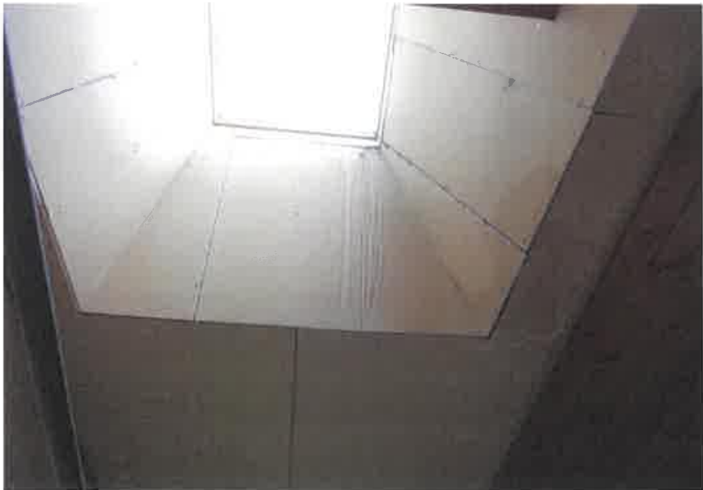
物件2:1階店舗部分の天窗付近の内壁のしみ等の状況
