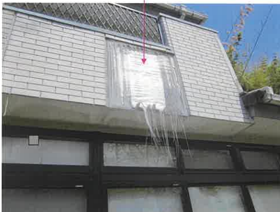
物件2:2階ベランダの外壁の欠損
