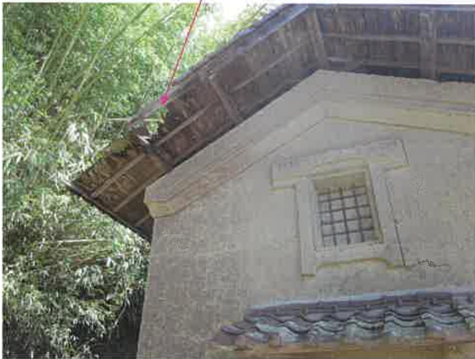
物件3: 物置の屋根の破損
