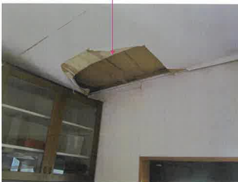
物件2:1階中央台所の天井の剥がれ
