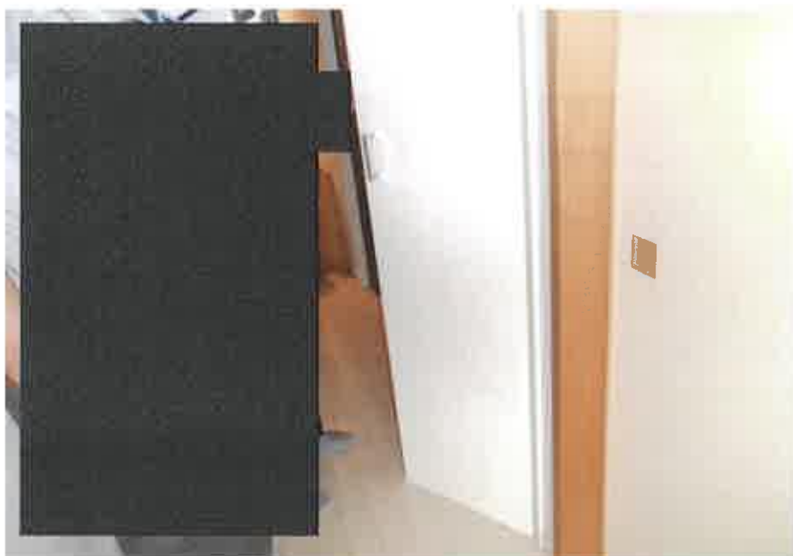
専有部分:廊下に面した物入開閉扉
