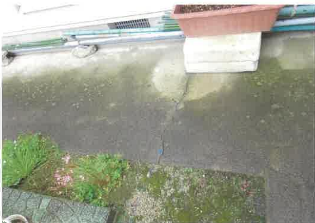
物件2:犬走り部分のひび
