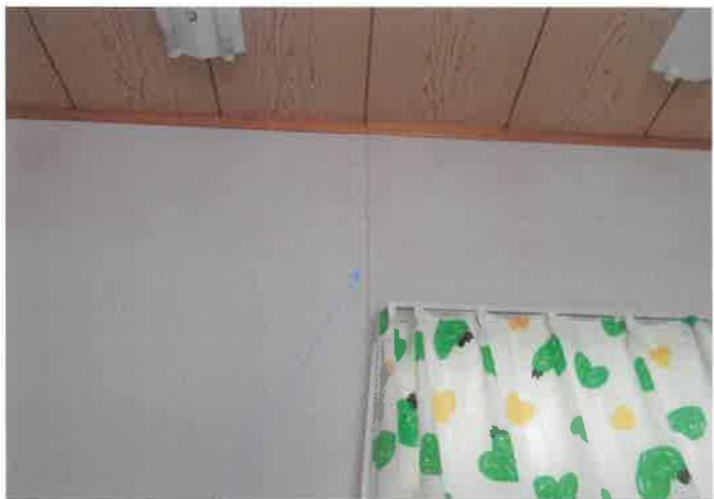
1階西側和室の内壁のひび
