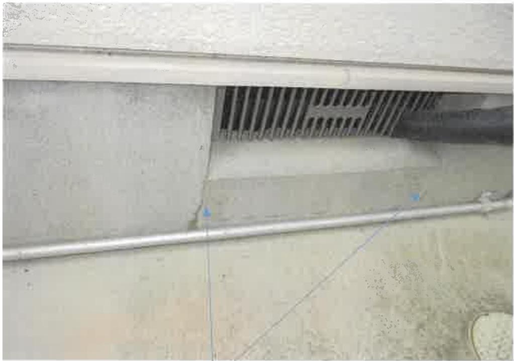
物件2:基礎部分のひび等
