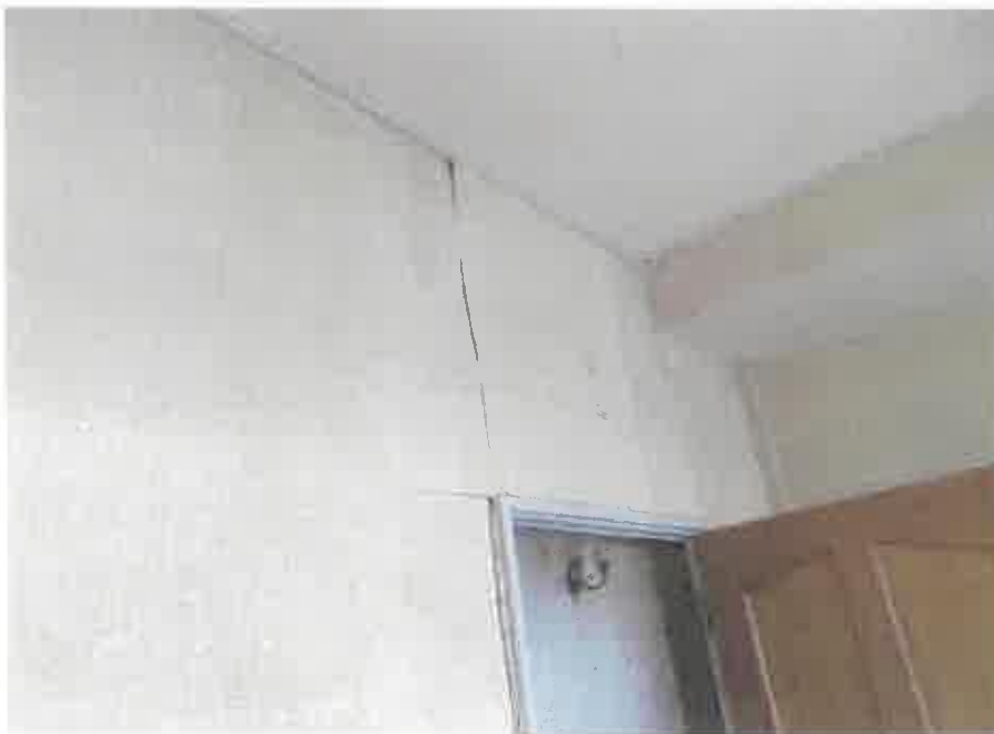
物件3主である建物:1階玄関脇の洋室 の内壁のひび等の状況
