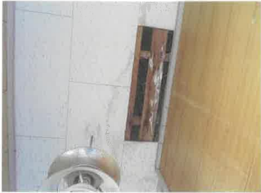
主である建物1階廊下の天井の破損状況
