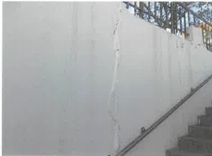
南東側階段のひびの状況
