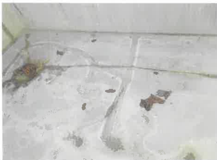
物件3主である建物2階ベランダのひび 割れの状況
