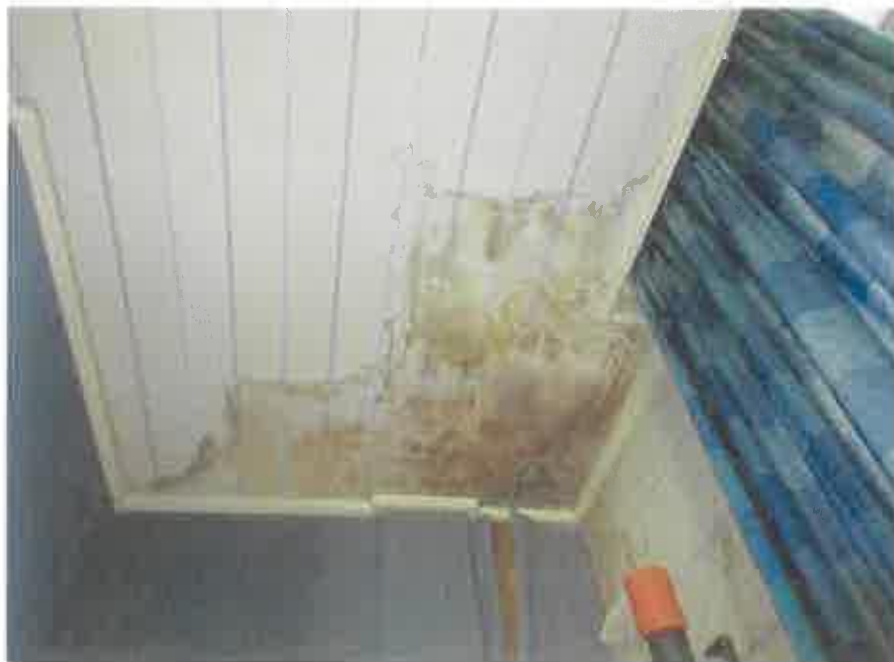
物件3主である建物2階東側洋室の天井 等の腐食状況
