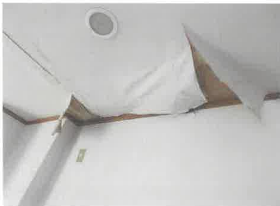
主である建物(別棟)1階のフリースペー スの天井の損傷等の状況
