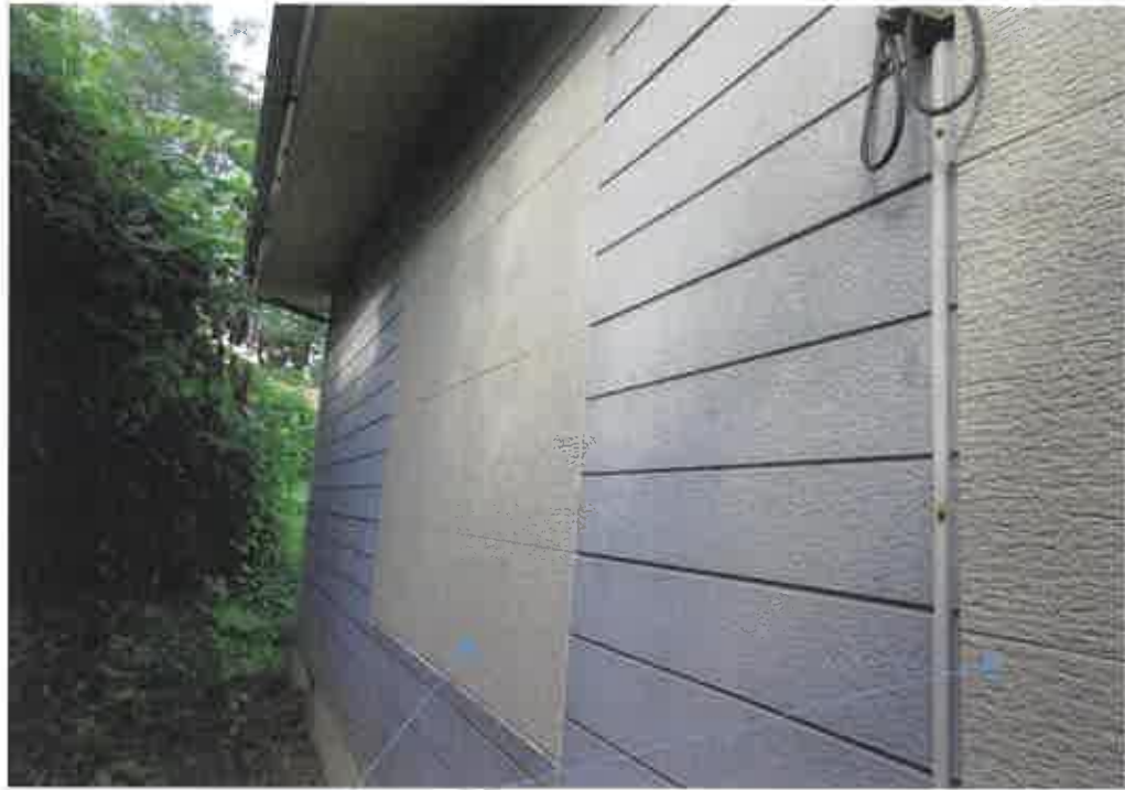
西側外壁の材質が異なる部分
