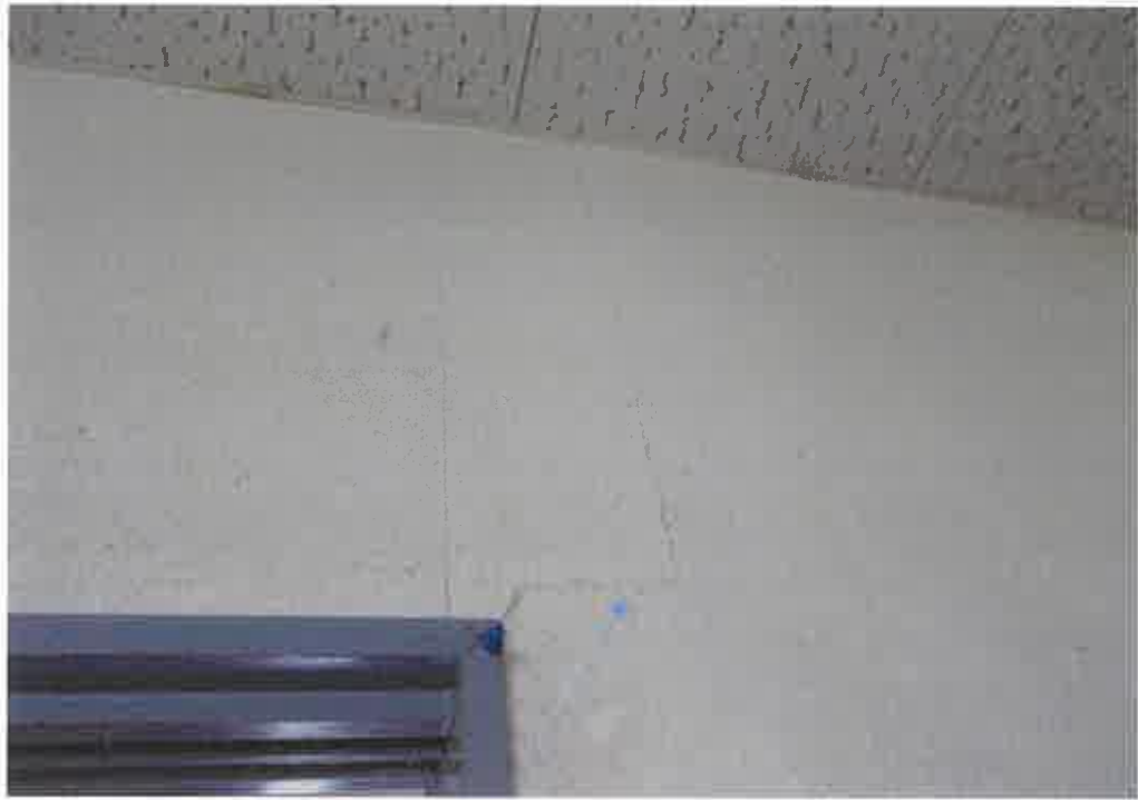
物件2:西側洋室の内壁クロスのひび等
