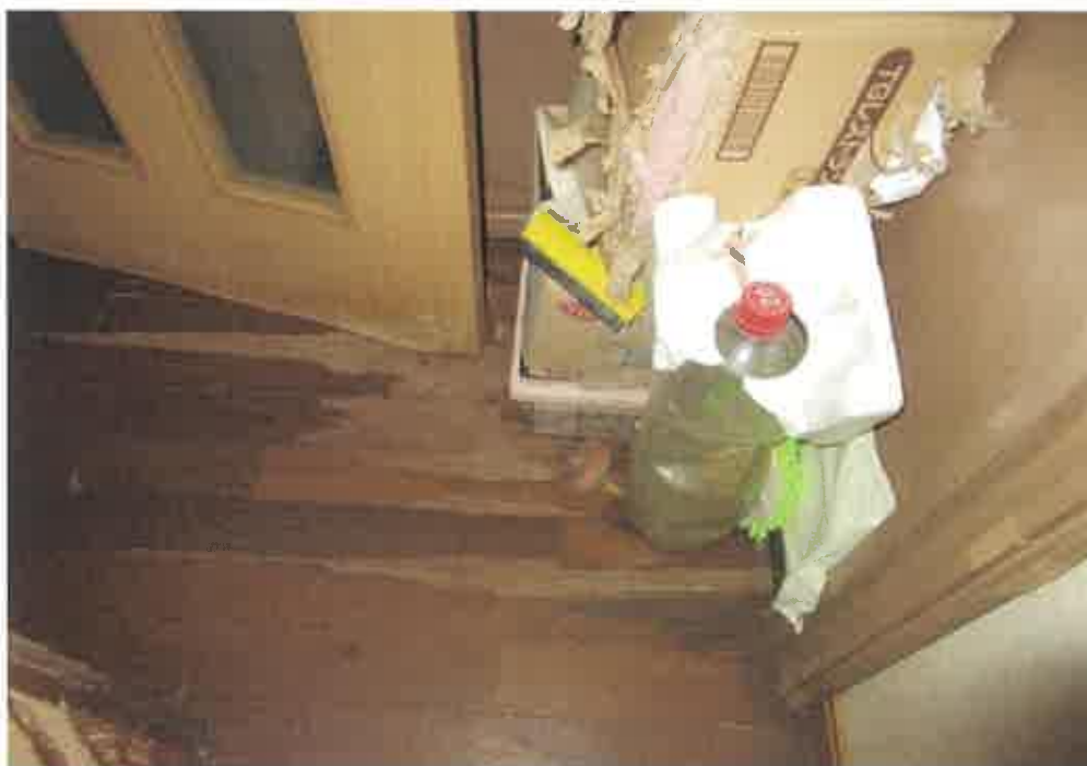
物件2主である建物:1階廊下の床等の損傷の状況
