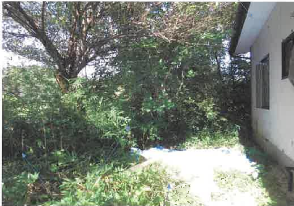
傾斜している部分
