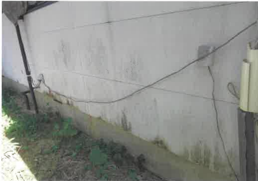
物件2主である建物:外壁の汚損等の状況
