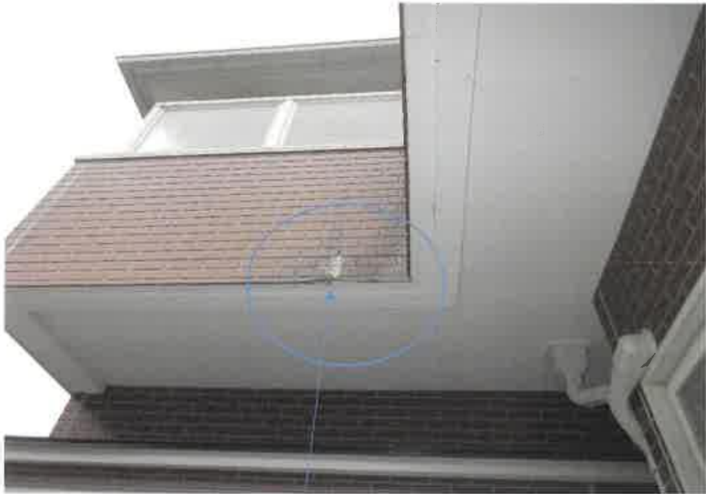
物件2:外壁の損傷等
