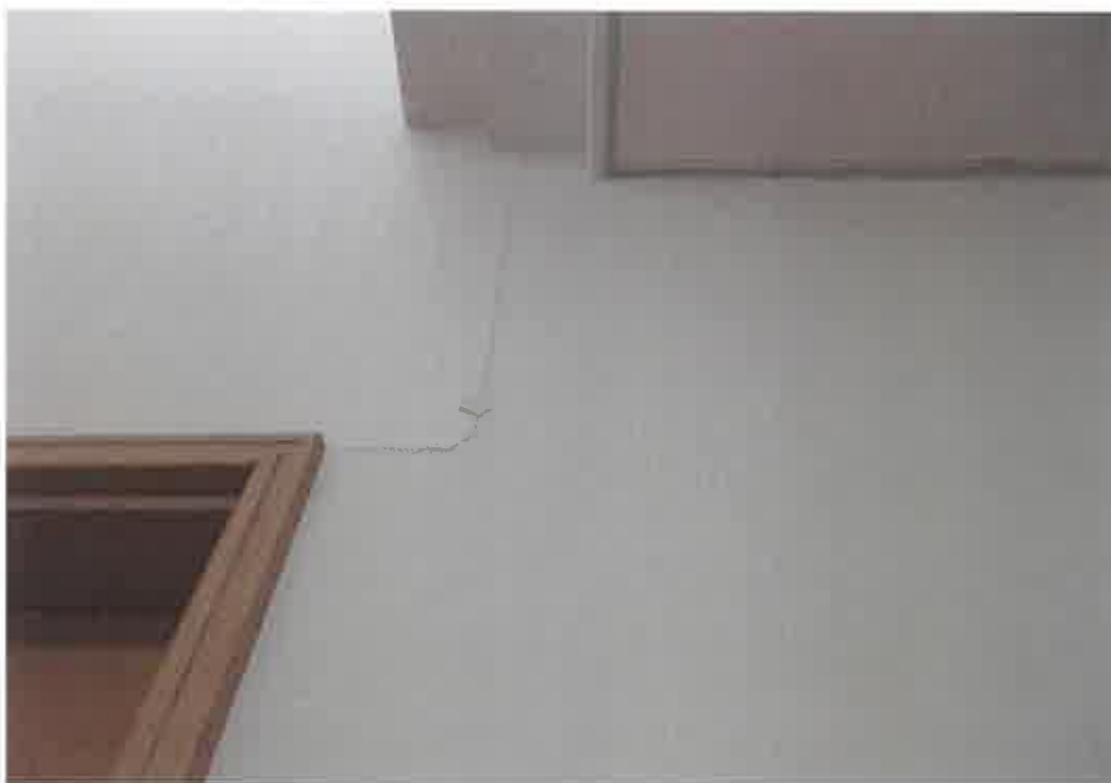
物件2:1階ダイニングの内壁クロスのひびの状況
