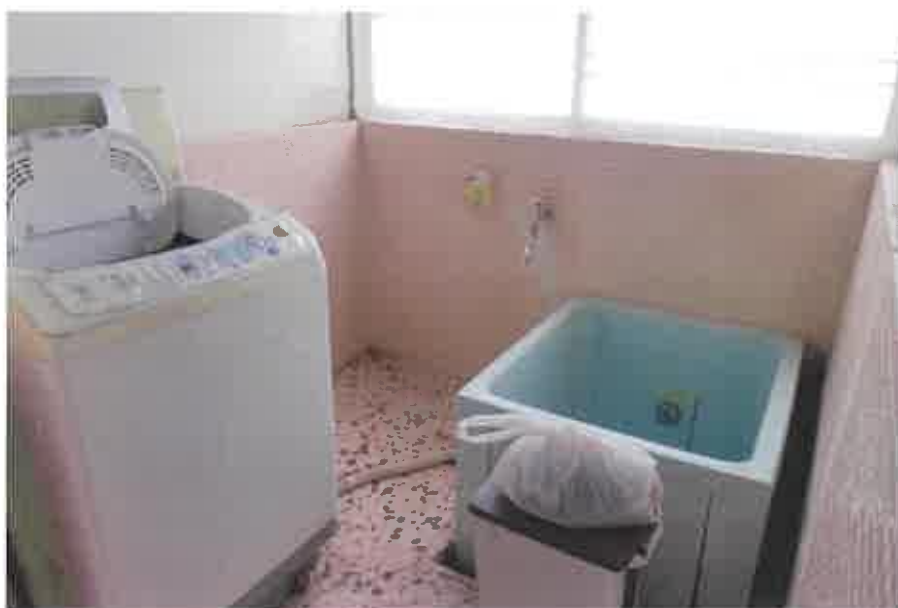
物件13主である建物:浴室の状況
