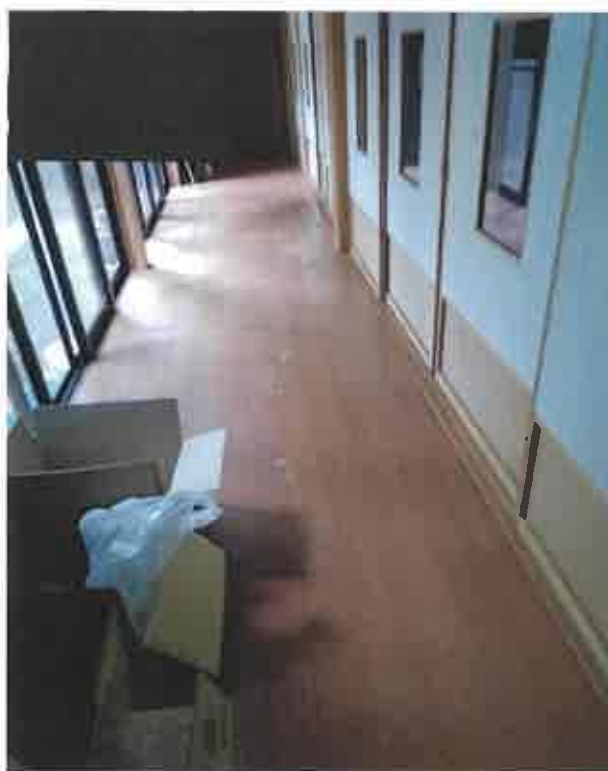
物件2:広縁部分の床の褪色の状況
