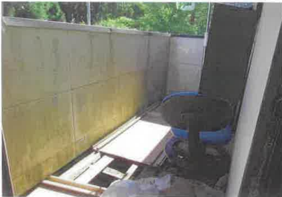
物件2主である建物:2階バルコニーの床部分 の損傷等の状況
