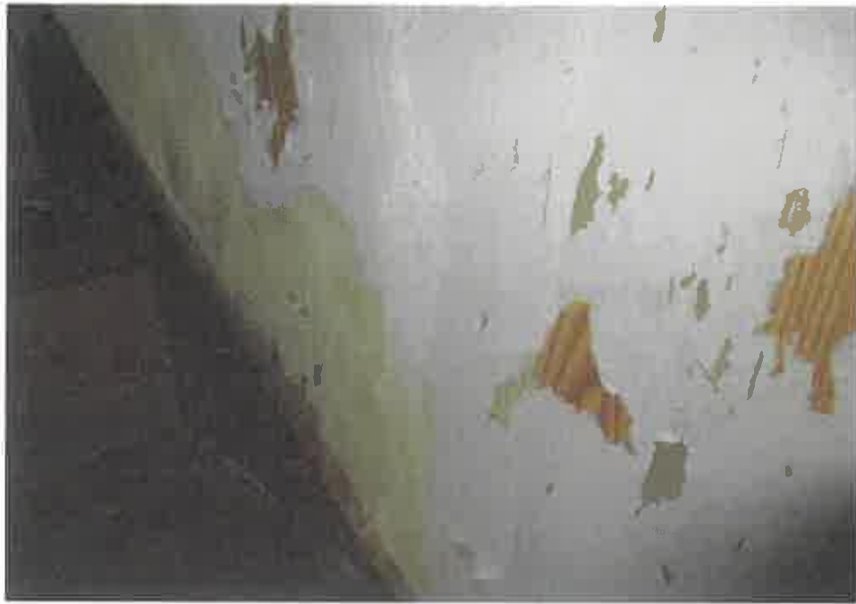
物件2主である建物:階段部分の内壁の損傷 等の状況
