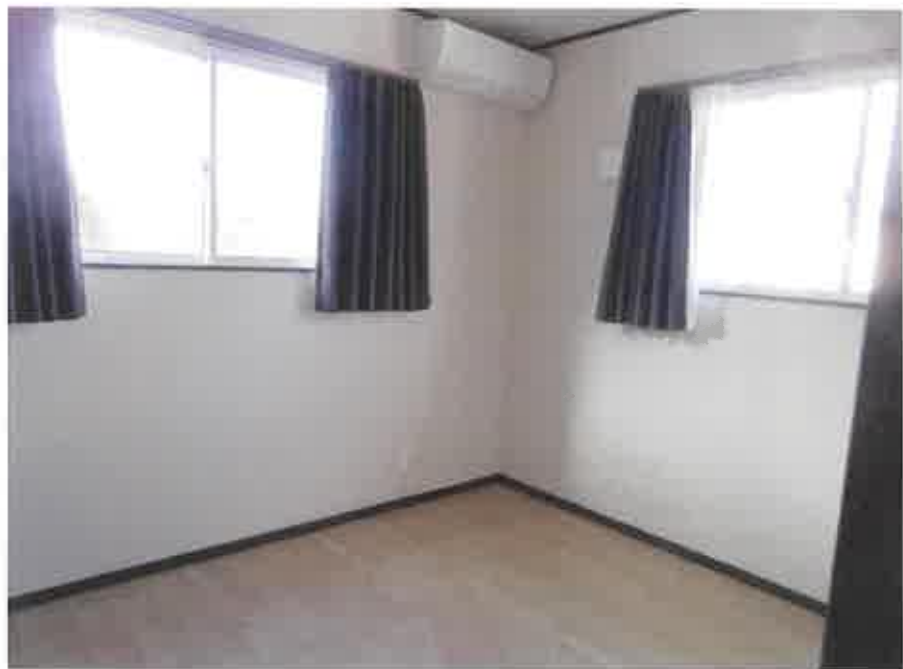
物件6:2階北西側洋室の状況
