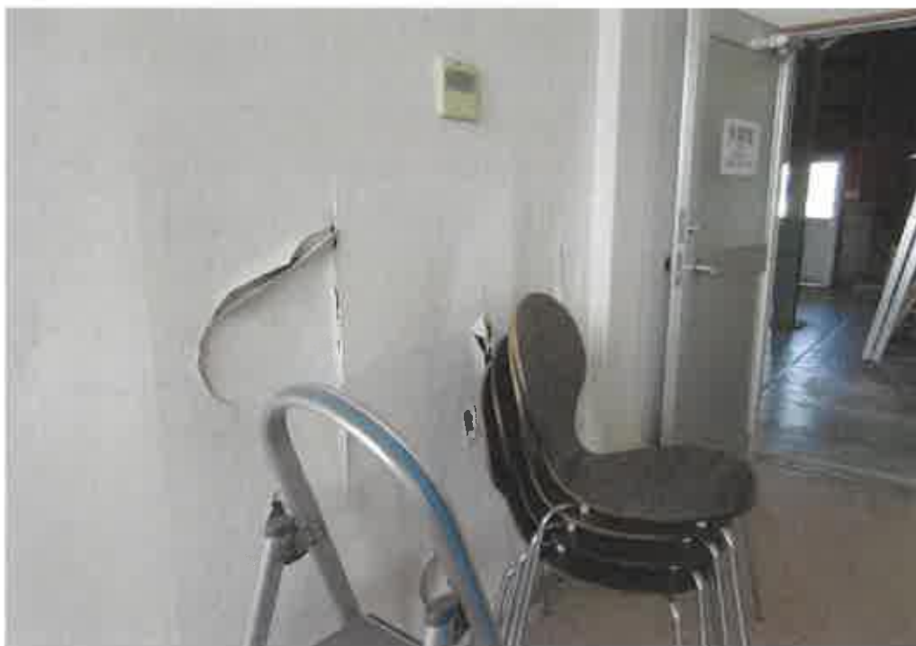
内壁の損傷等の状況
