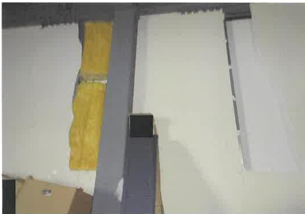
内壁の損傷等の状況
